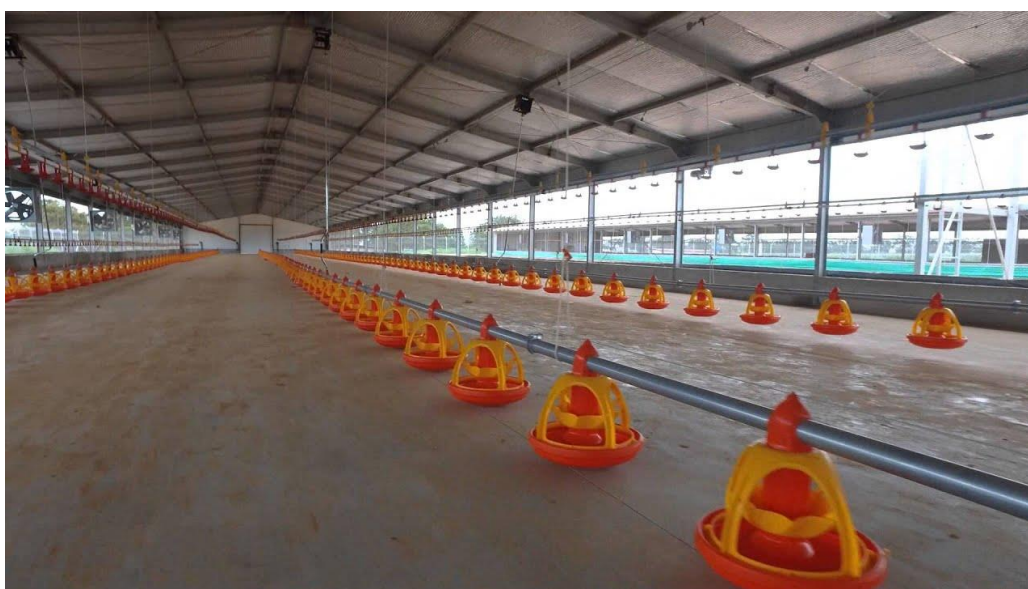
Figura 14 34 : Vista de uma instalação do projeto Quiminha.
