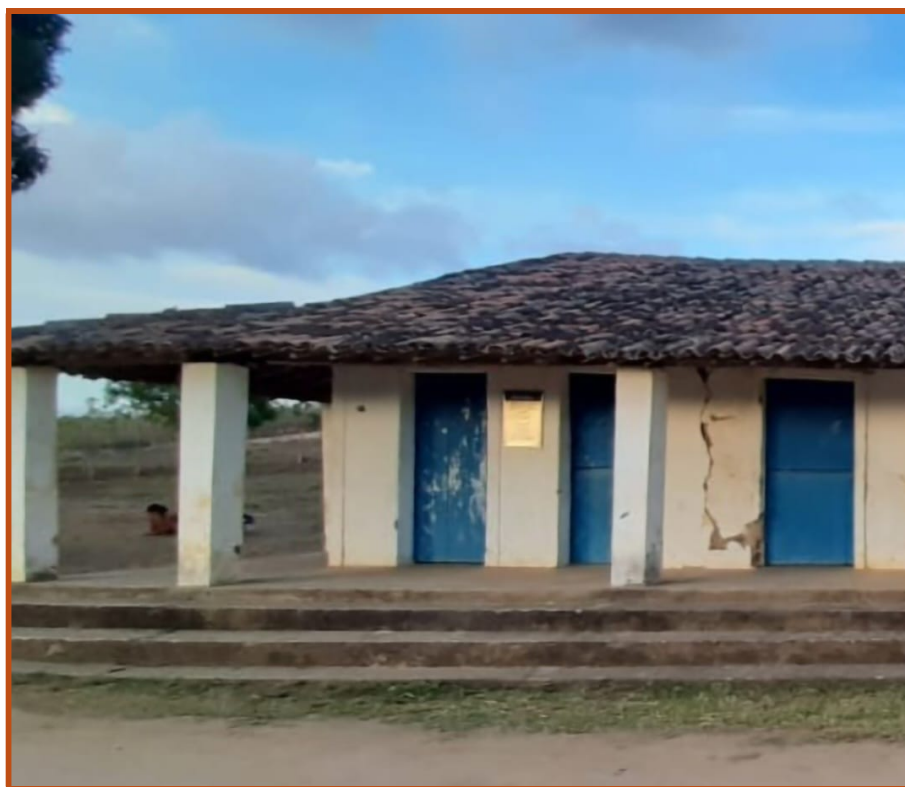
Imagem 82: Fachada lateral do MLLC, com destaque para a rachadura na parede. Foto de Weverton Rodrigues, 2023.
