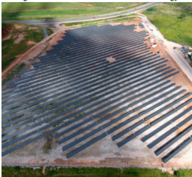
Figura 9 - Foto aérea da UFV Ribeirão Energy.
