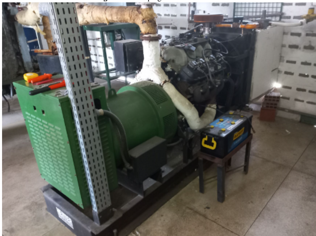
Figura 4.5: Grupo gerador Leon Heimer
