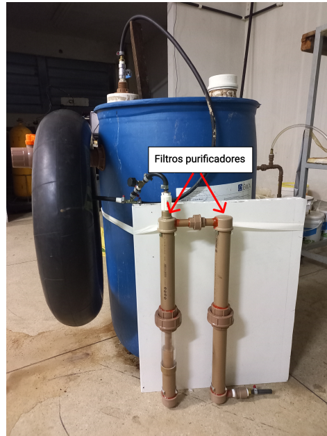
Figura 4.4: Filtros purificadores e biodigestor
