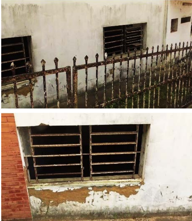
Figura 29 – Detalhes de danificação do edifício da antiga casa de saúde
