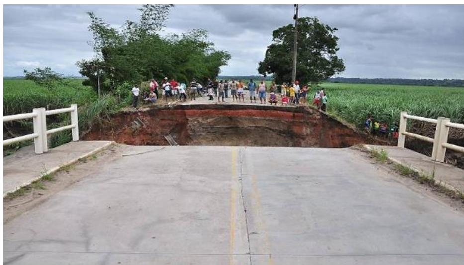
Figura 2 – Ponte da Batalha, Santa Rita - 09/07/2011
