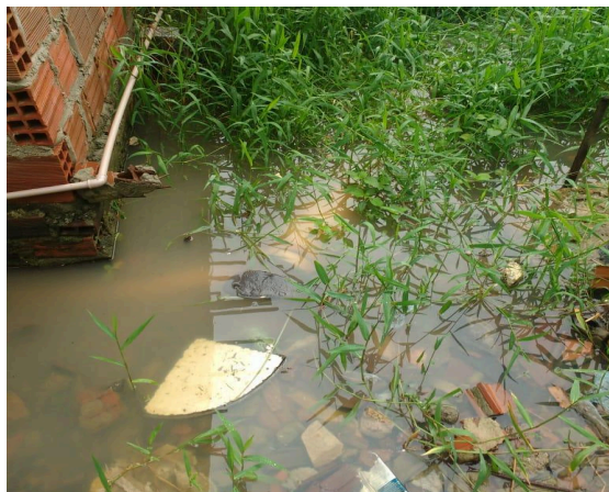
Figura 10 – Alagamento do terreno da primeira casa após chuva.
