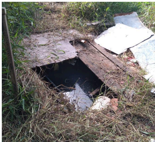
Figura 17 – Fossa da primeira casa cheia de água da chuva e esgoto
