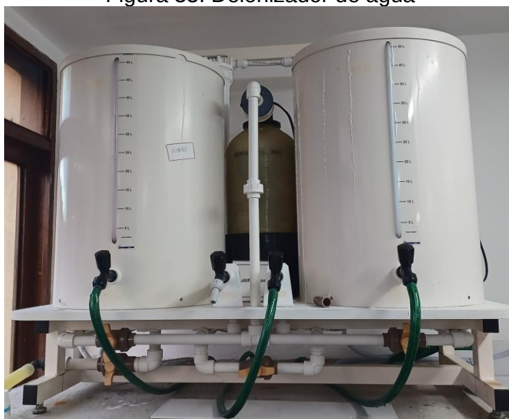
Figura 33: Deionizador de água
