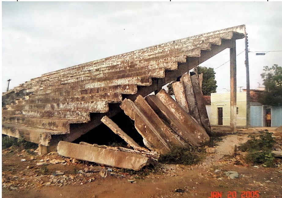
Figura 14: Comprometimento da estrutura física referente à arquibancada do Estádio Municipal Plínio Lemos.
