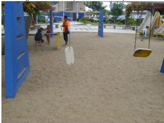
Figura 29: Balanço sem manutenção
