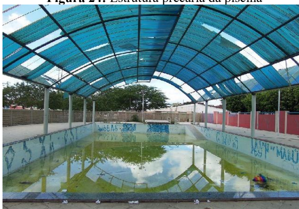
Figura 24: Estrutura precária da piscina
