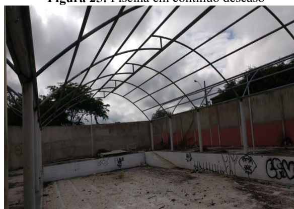
Figura 25: Piscina em contínuo descaso
