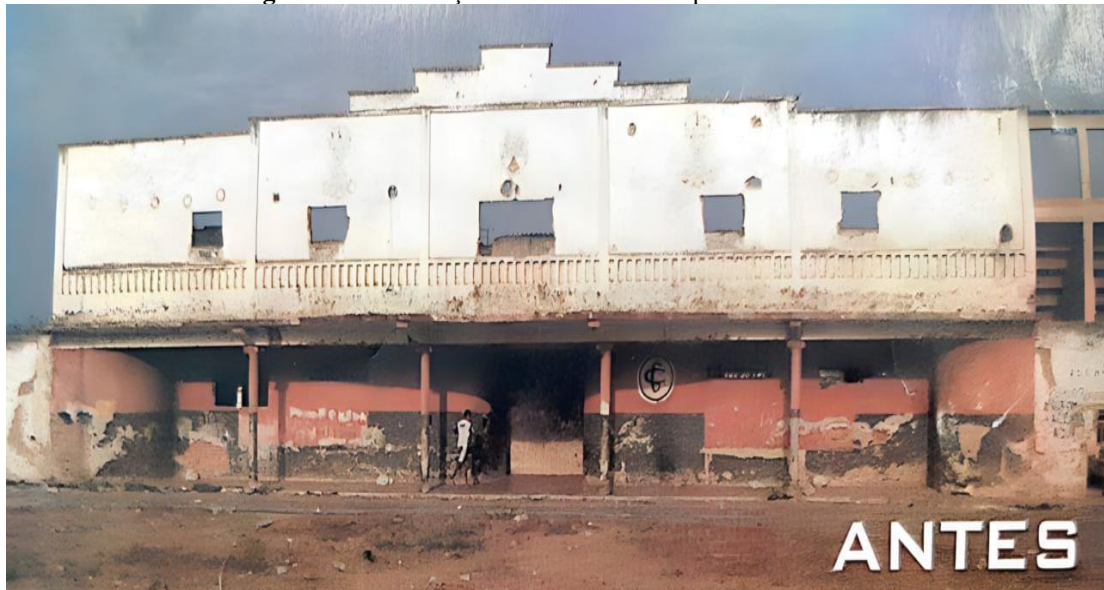
Figura 8: Deterioração do Estádio Municipal Plínio Lemos
