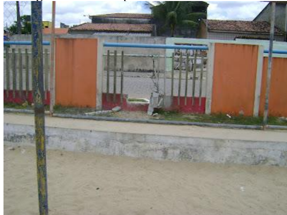
Figura 30: Muro quebrado com acesso à rua
