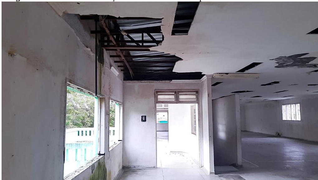
Figura 41: Estado de deterioração física do Museu do Esporte José Aurino de Barros Filho.
