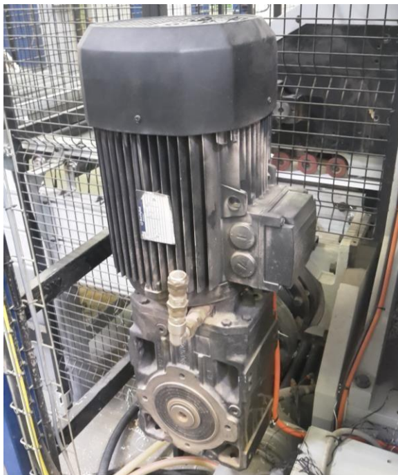
Figura 5.8 - Exemplo de moto redutor/ Autoria própria.
