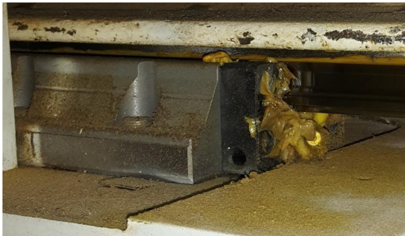
Figura 5.1 - Carro guia com lubrificação em excesso. Fonte: Autoria própria.
