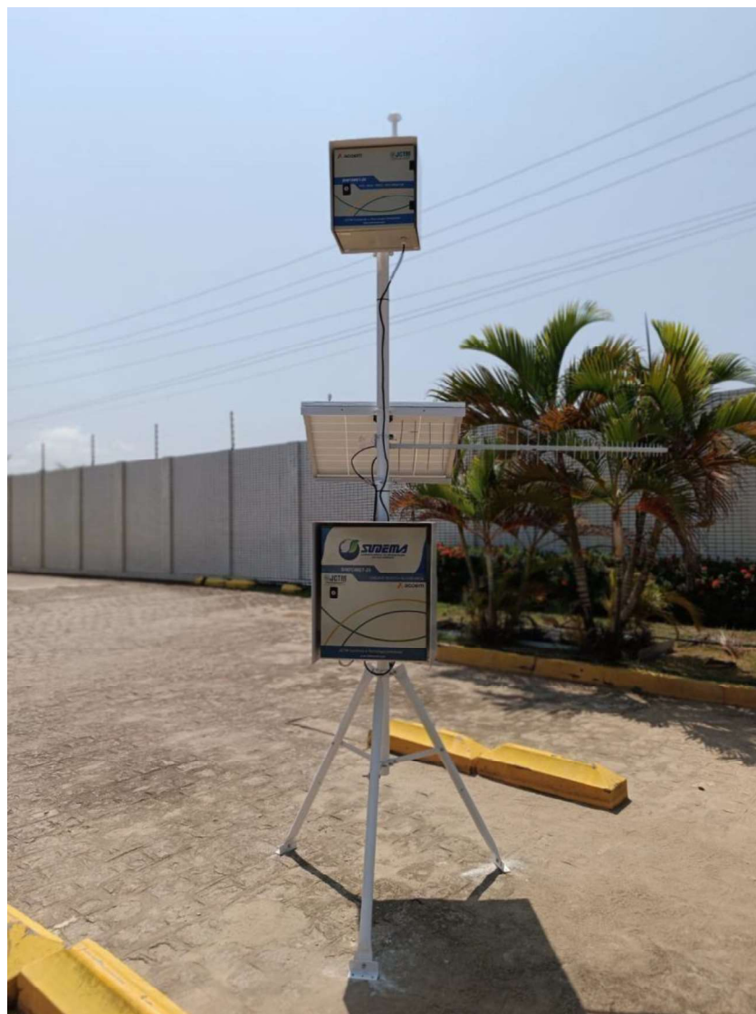
Figura 7 – Estação de monitoramento de qualidade do ar, instalada na VITRIUM, em Cabedelo.
