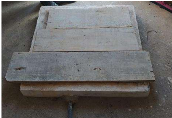
Figura 10 – Reservatório enterrado da UPA Bancários
