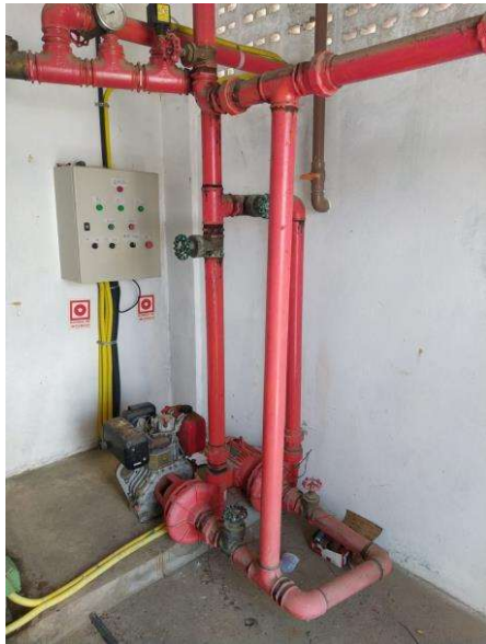
Figura 11 - Bomba responsável pelo transporte de água do poço até a cisterna na UPA Bancários
