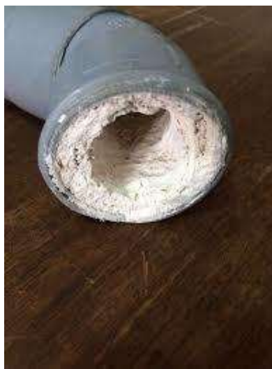
Figura 3 - Tubulação com grande quantidade de incrustação acumulada
