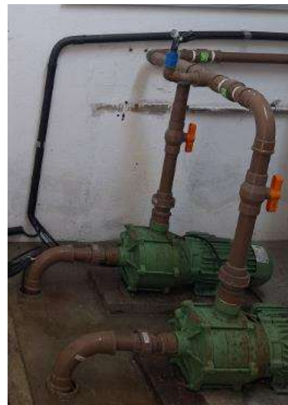
Figura 8 - Bomba responsável pelo transporte de água da cisterna até a caixa d'água da UPA Cruz das Armas
