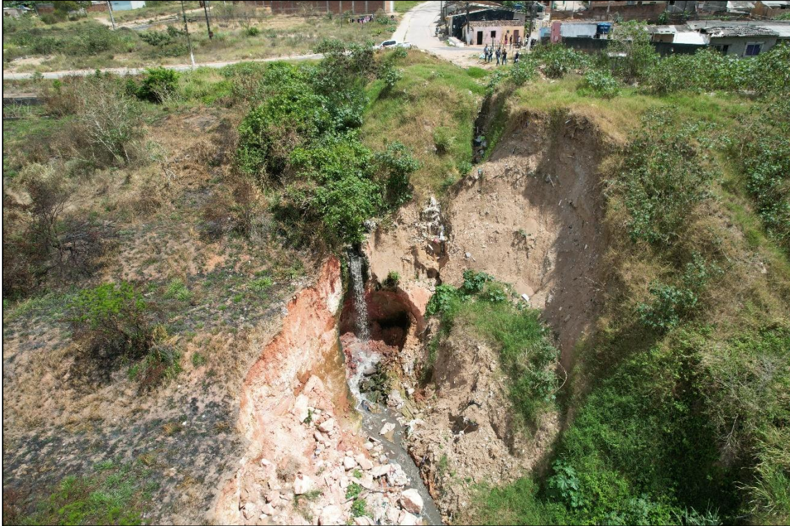
Figura 51 Tubulação de esgoto despejando resíduos em voçorocas em Garanhuns, Pernambuco.
