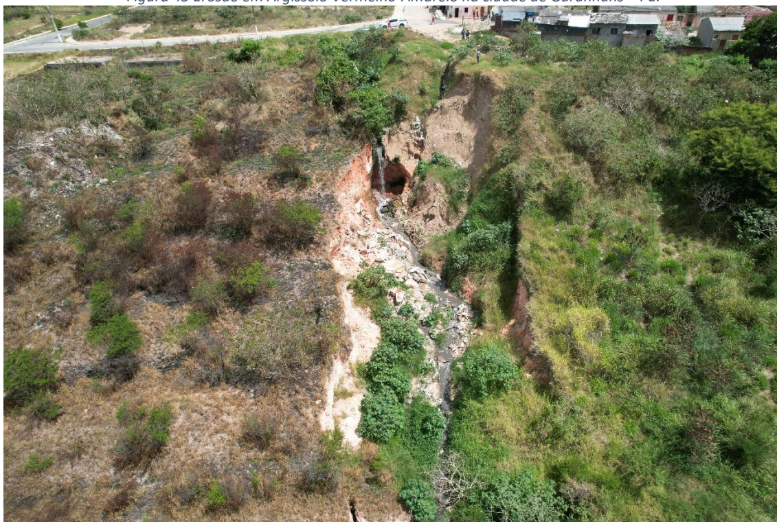
Figura 45 Erosão em Argissolo Vermelho-Amarelo na cidade de Garanhuns – PE.
