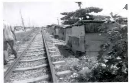
Ilustração 2: Casas construídas em cima da banquetagem, comprometendo a Infra e Superestrutura da Via, além do risco de colisões e atropelamentos.
