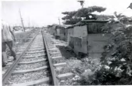
Ilustração 2: Casas construídas em cima da banquetta, comprometendo a Infra e Superestrutura da Via, além do risco de colisões e atropelamentos.
