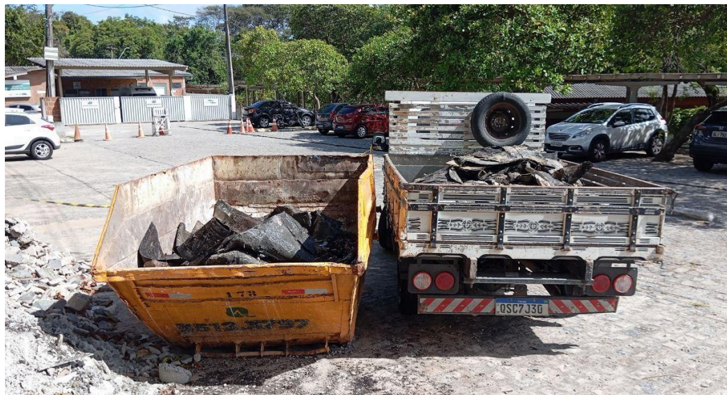
Figura 15. Caçamba no CCM contendo Mantas Asfálticas
