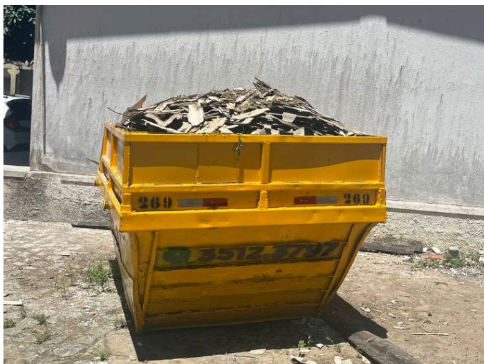
Figura 24. Caçamba N° 269, contendo os resíduos Classe I, proveniente da cobertura do CTN 105 e 106, localizadas no LAMAB
