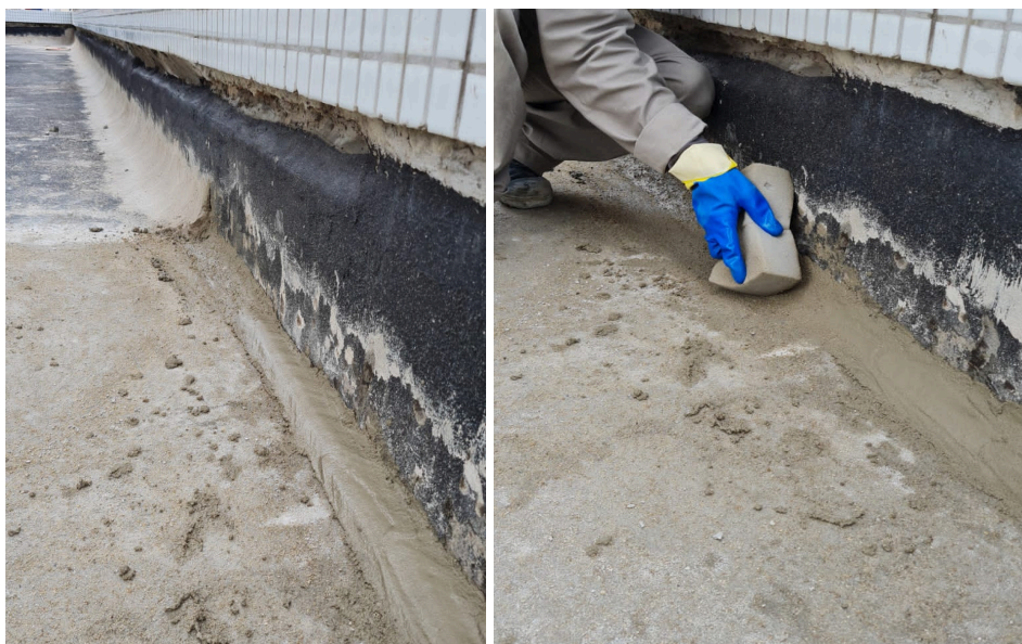
Figura 22 - Rodapé: (a) Correção da meia-cana e b) Acabamentos de regularização
