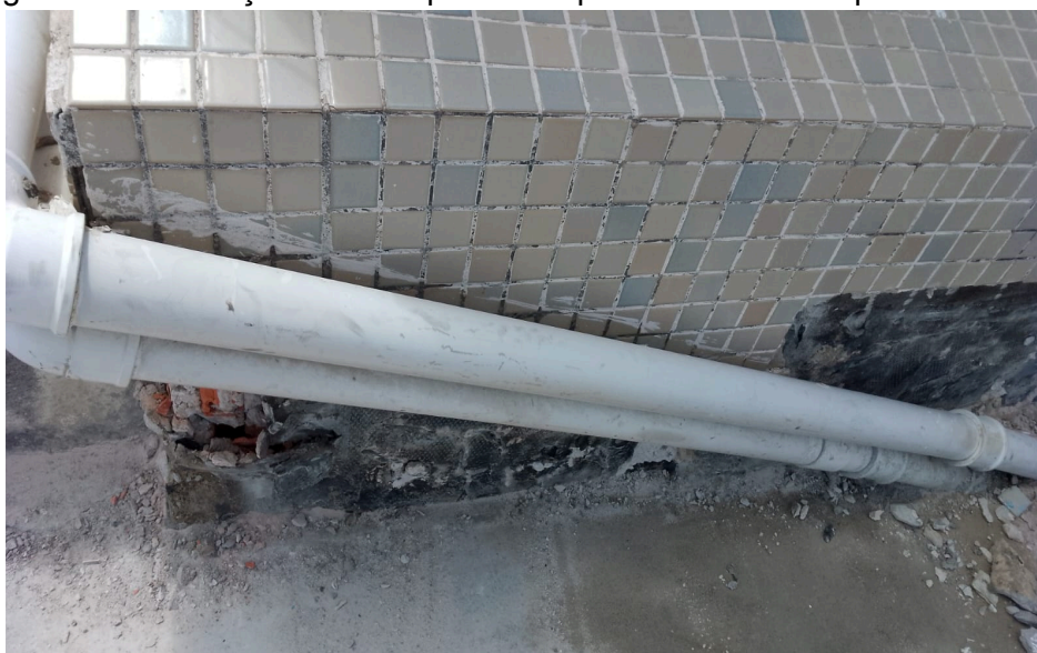
Figura 26 - Tubulações aéreas passando paralelamente aos planos verticais
