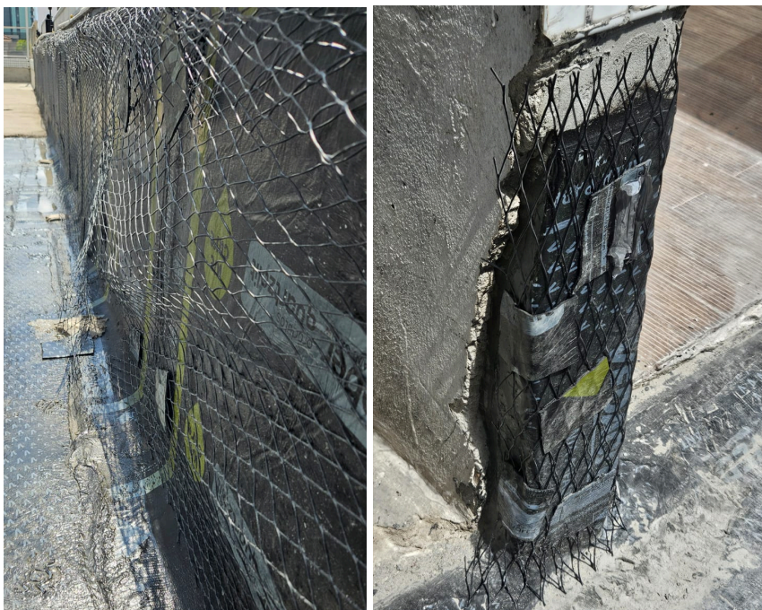
Figura 32 – Fixação inadequada de arame sobre a manta
