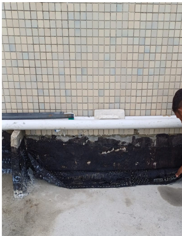
Figura 23 - Manta descolada do rodapé na obra B
