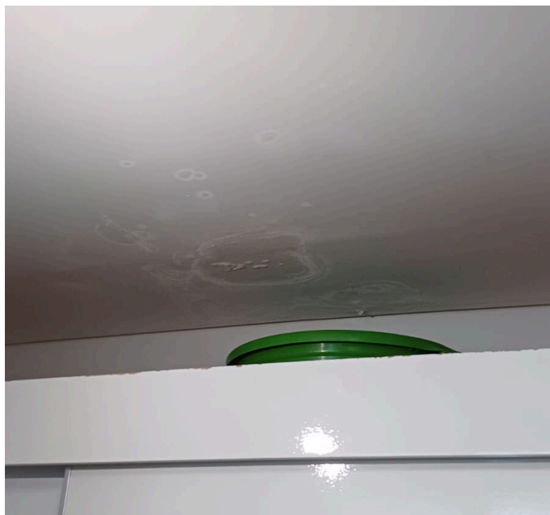
Figura 6 - Infiltrações decorrentes de danos ao sistema de impermeabilização em áreas privativas da obra B
