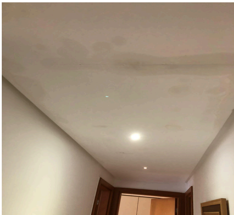
Figura 5 - Infiltrações decorrentes de danos ao sistema de impermeabilização em áreas privativas da obra B
