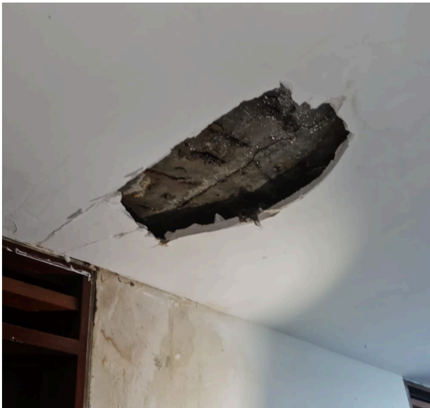
Figura 28 – Armadura de viga exposta à água proveniente de infiltração causada por ineficiência do sistema de impermeabilização antes da manutenção na obra C.
