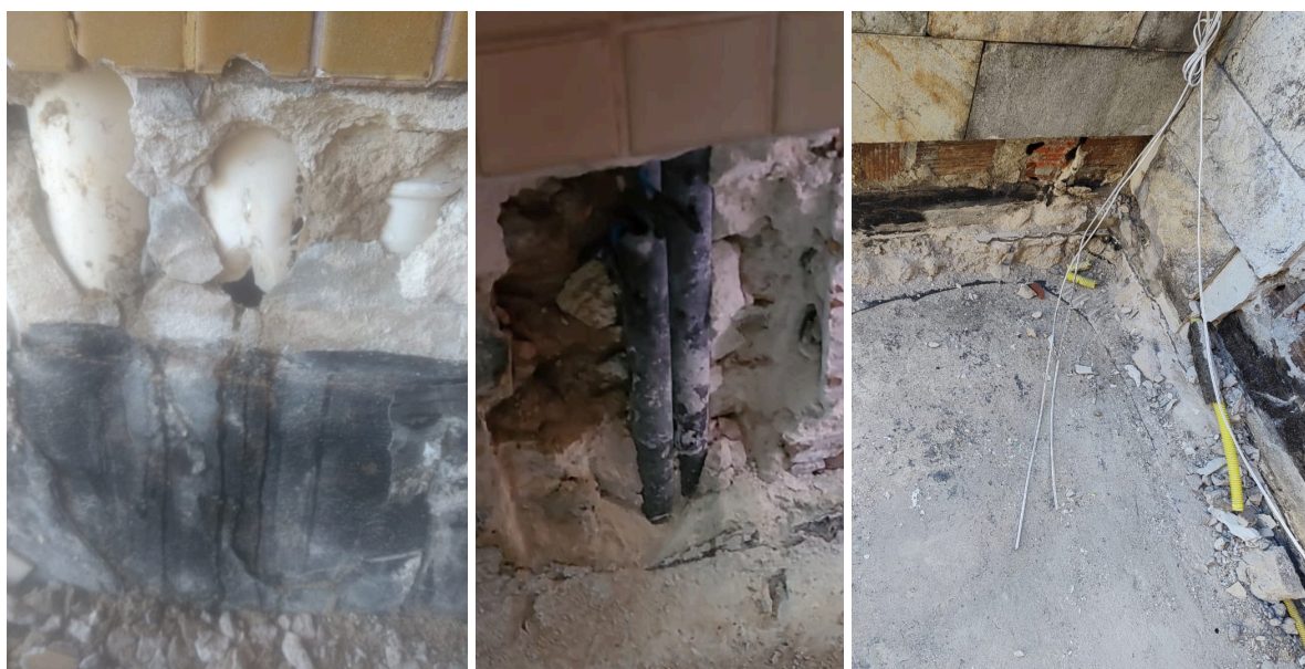
Figura 18 - Instalações de esgoto sanitário e elétrica danificadas.
