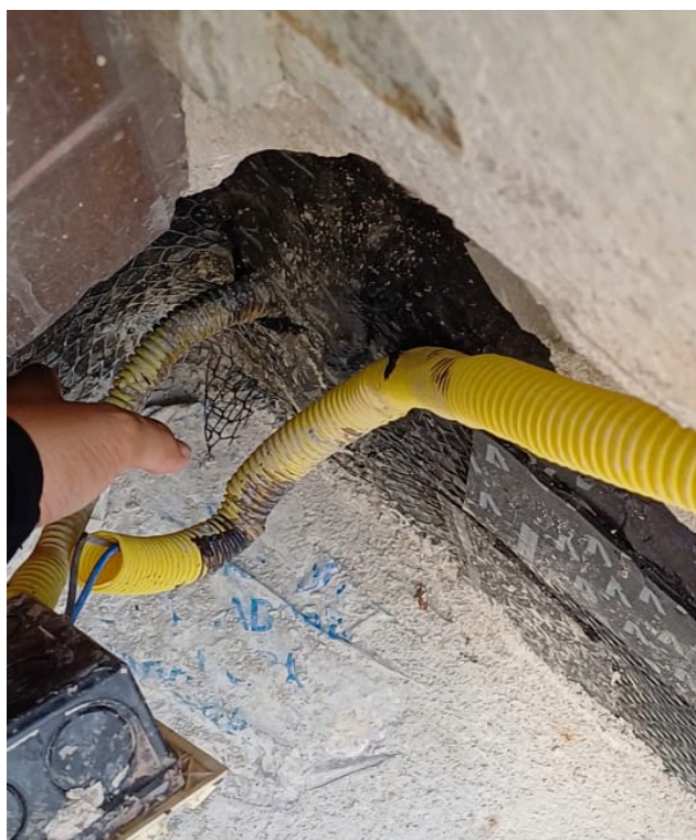
Figura 27 - Tubulação passante na impermeabilização sem proteção ou arremate específico
