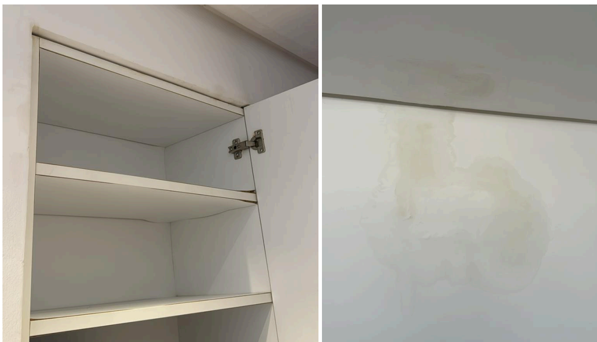
Figura 7 - Danos causados à mobília e à pintura de apartamento da obra B
