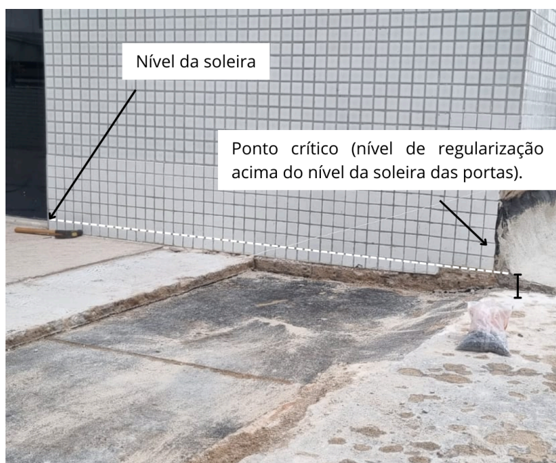
Figura 12 - Ponto crítico na execução do serviço
