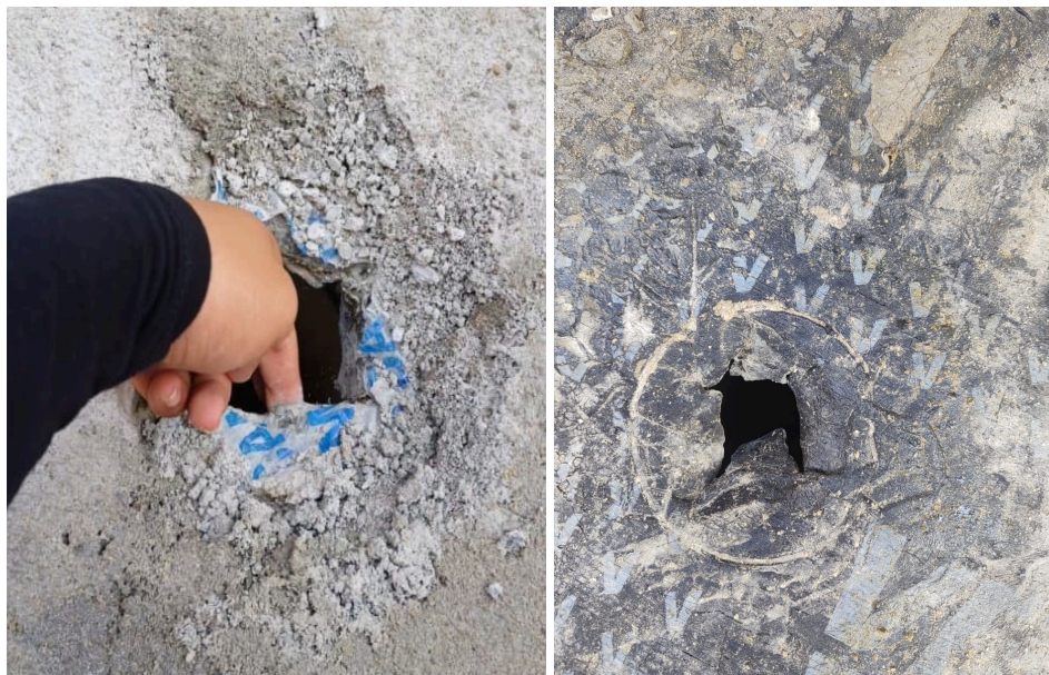
Figura 24 - Erro na execução do arremate da manta nos ralos
