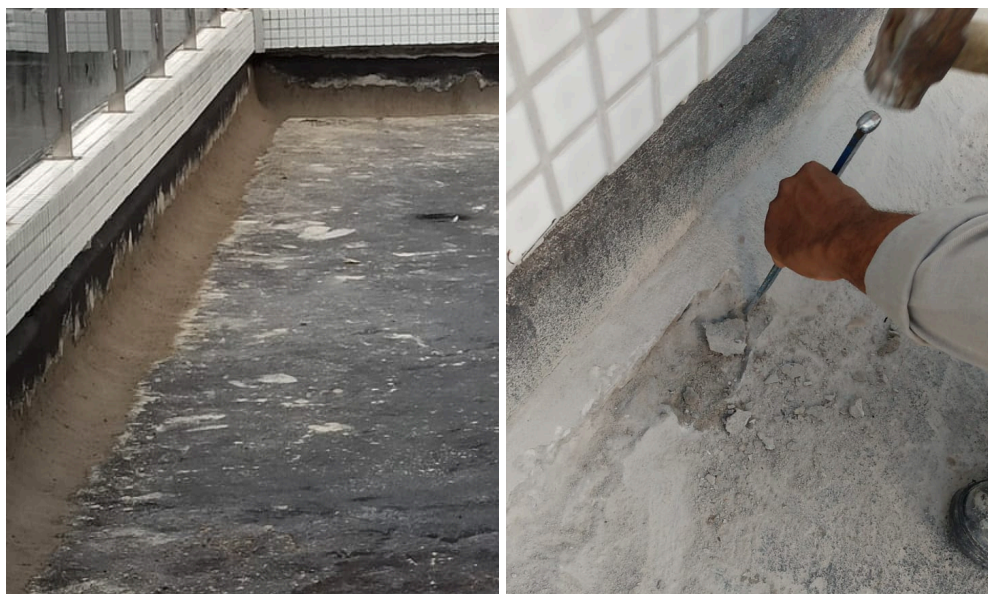
Figura 21 - (a) Meia-cana executada com raio inadequado e (b) demolição.
