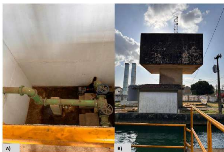
Figura 27 – Fotografias da EEAT1 e RE1.
