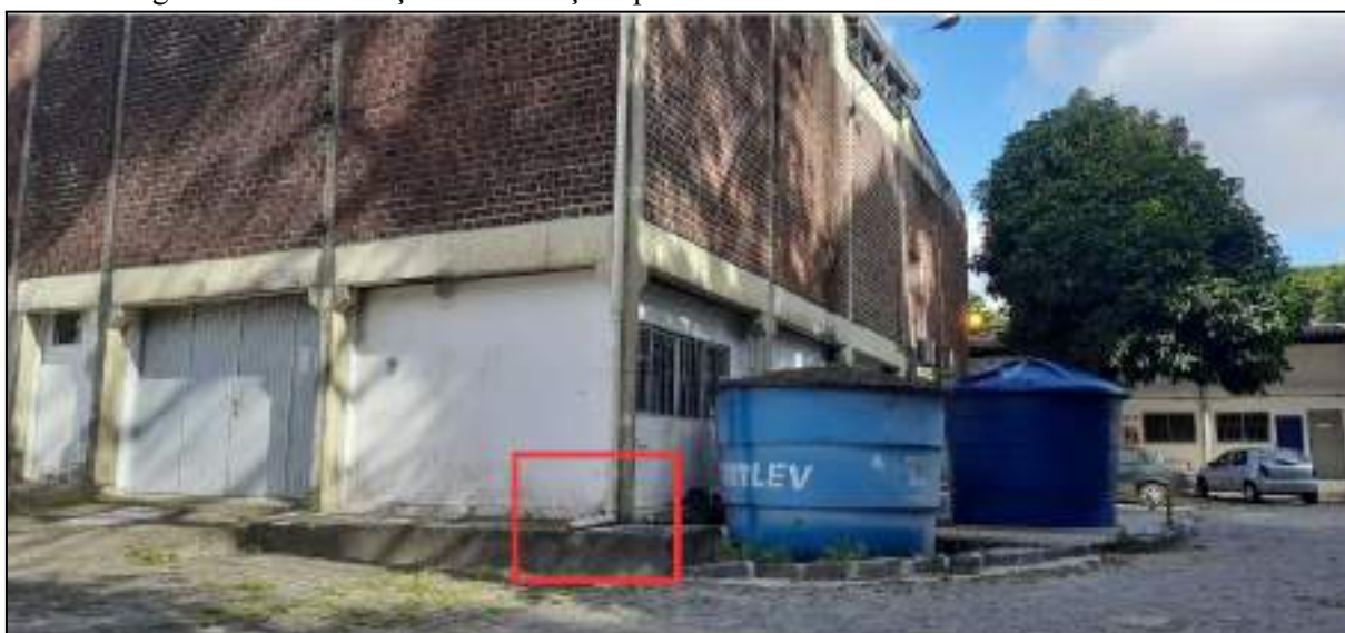
Figura 35: Identificação de tubulações para coleta e direcionamento do escoamento.
