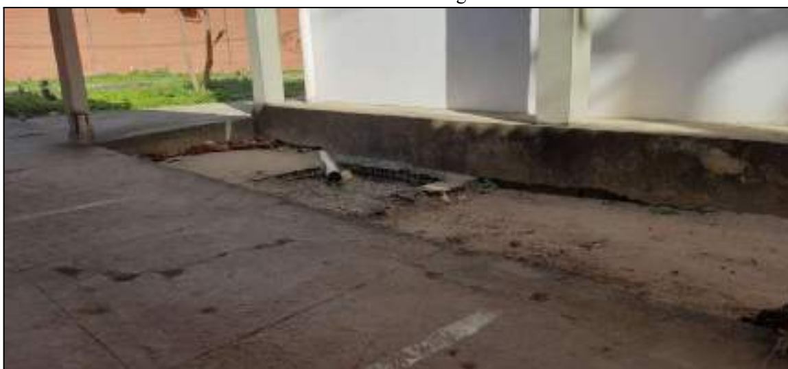
Figura 36: Identificação de tubulações para coleta e direcionamento do escoamento direcionado a estrutura com material granular.
