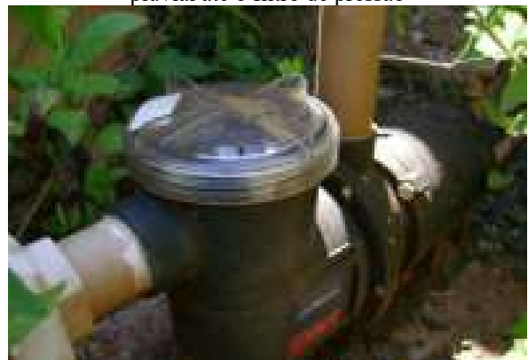
Figura 49: Bomba utilizada para encaminhar a água pluvial até o filtro de pressão
