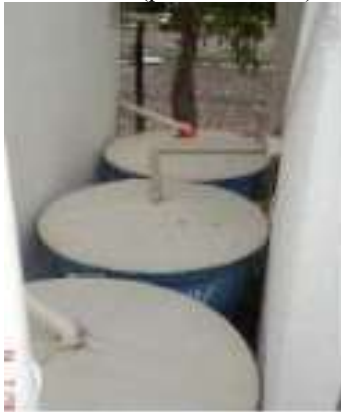
Figura 27: Reservatório de armazenamento da água da chuva (pré-tratamento)
