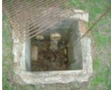
Figura 44: Caixa de Desvio
