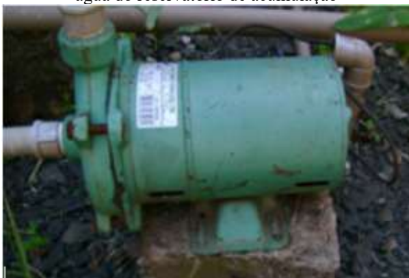
Figura 48: Bomba utilizada para homogeneização da água do reservatório de acumulação
