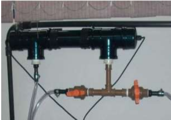
Figura 72: Unidade de desinfecção por UV.
