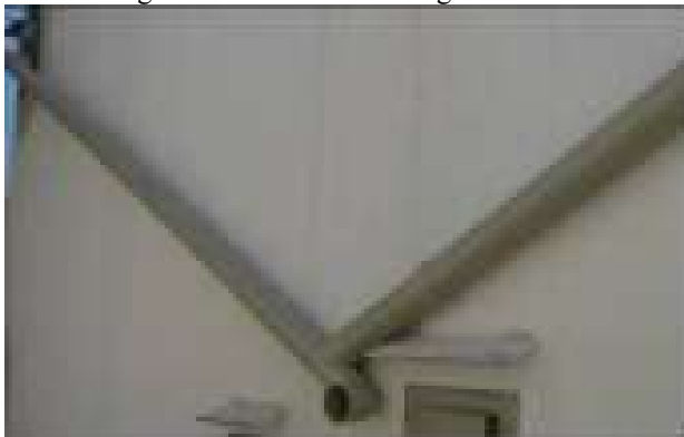
Figura 25: Condutores da água da chuva
