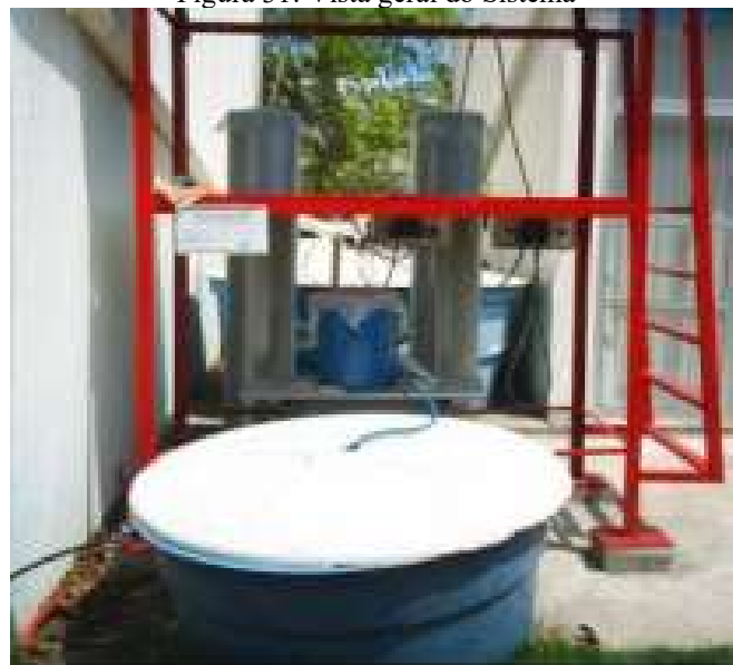
Figura 31: Vista geral do Sistema
