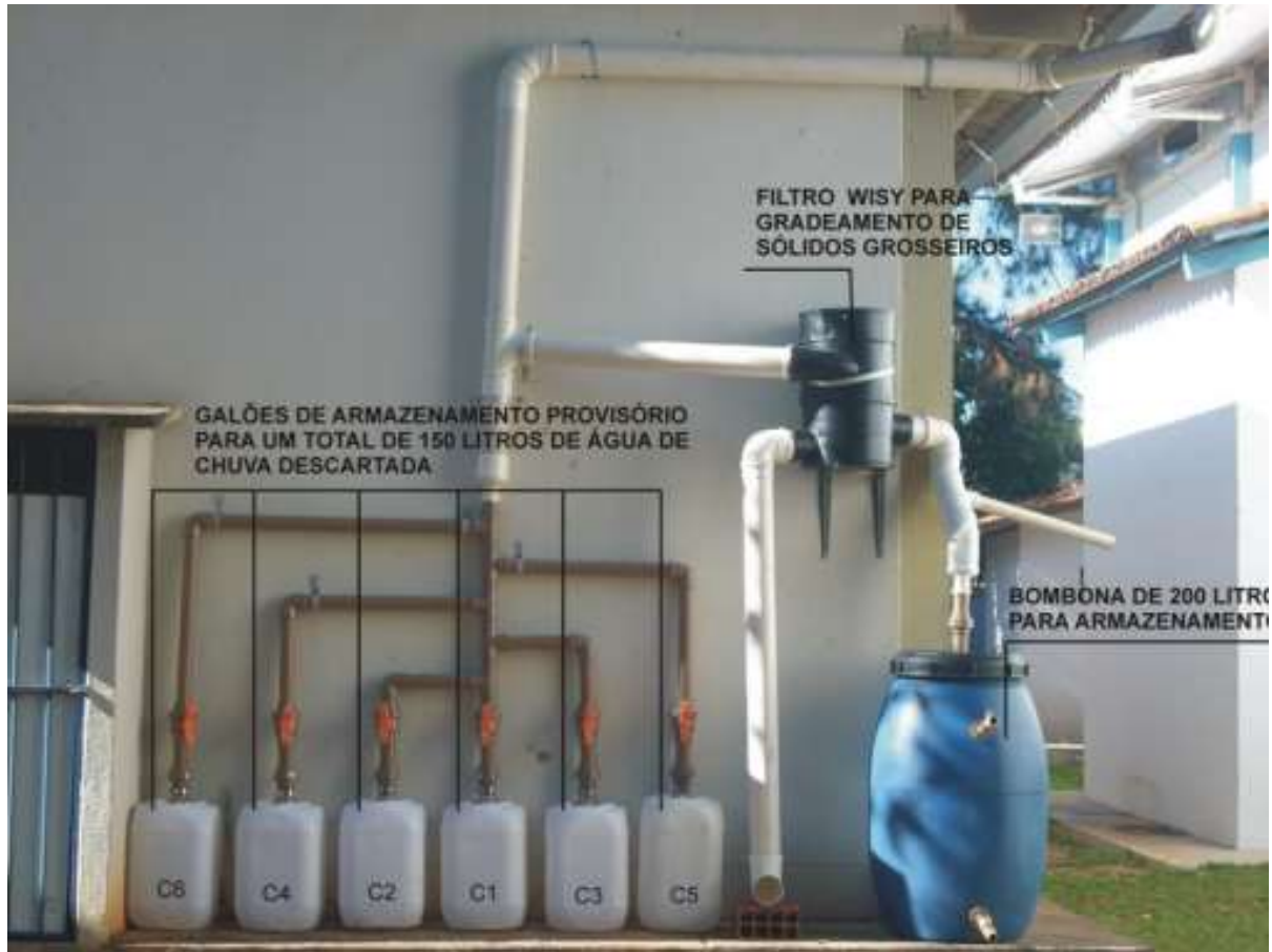
Figura 61: Sistema de captação, descarte, filtração para retenção de sólidos grosseiros e armazenamento de água de chuva
