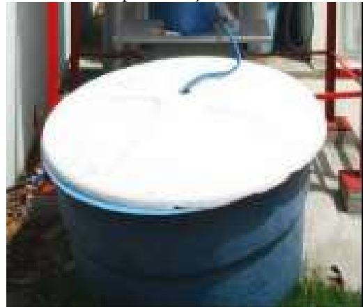
Figura 30: Reservatório de armazenamento da água após Filtração lenta
