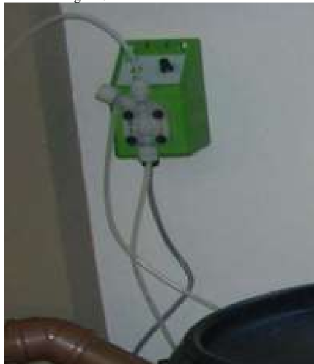
Figura 74: Bomba dosadora de cloro
