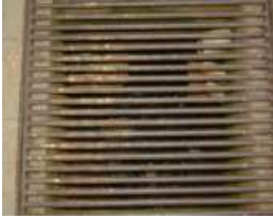
Figura 43: Caixa de Passagem
