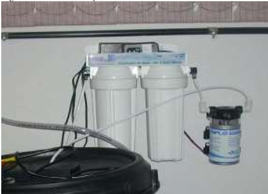
Figura 62: Sistema de filtração constituído de dois filtros de celulose de 25 micras.
