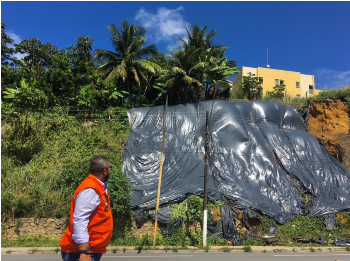
Figura 9: Lona de contenção na Avenida Leste Oeste. Fonte: Isabela Keyla Silva (Defesa Civil de Maceió), 2021.
