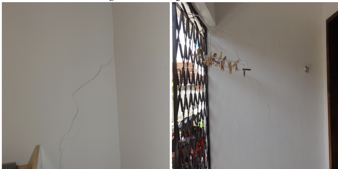
(a) Fissura interna
