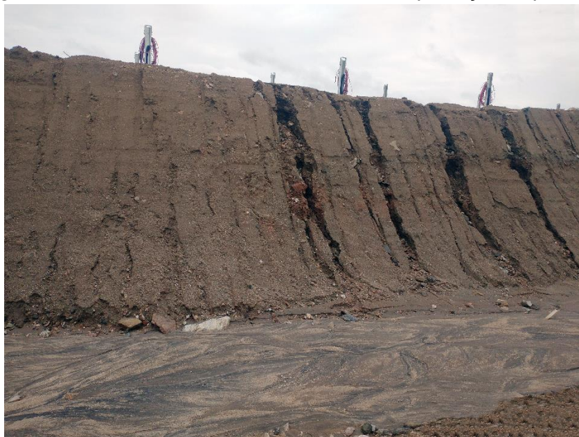
Figura 01 – Erosões em face de talude sem proteção superficial
