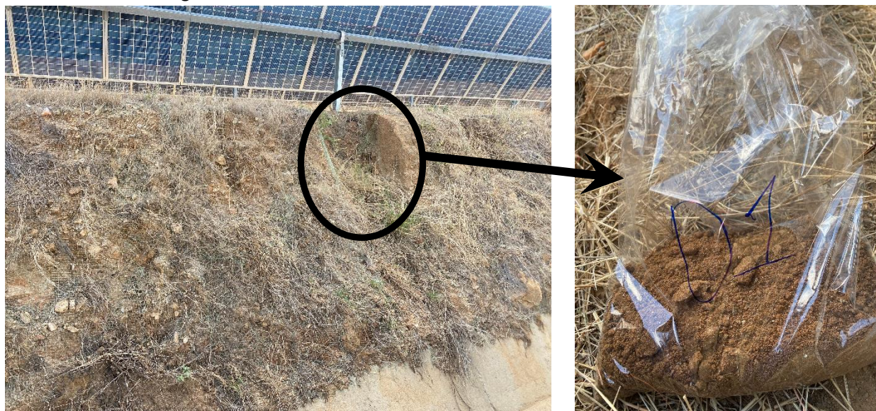
Figura 18 – Ponto de amostra deformada do Talude 01
