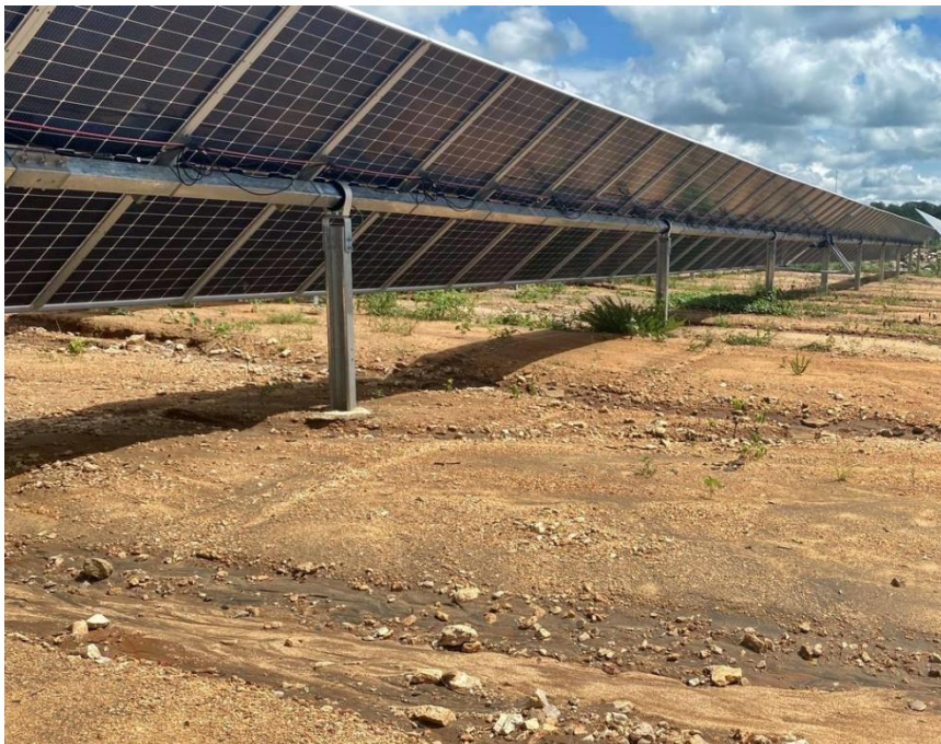
Figura 05 – Seguidor solar de eixo horizontal
