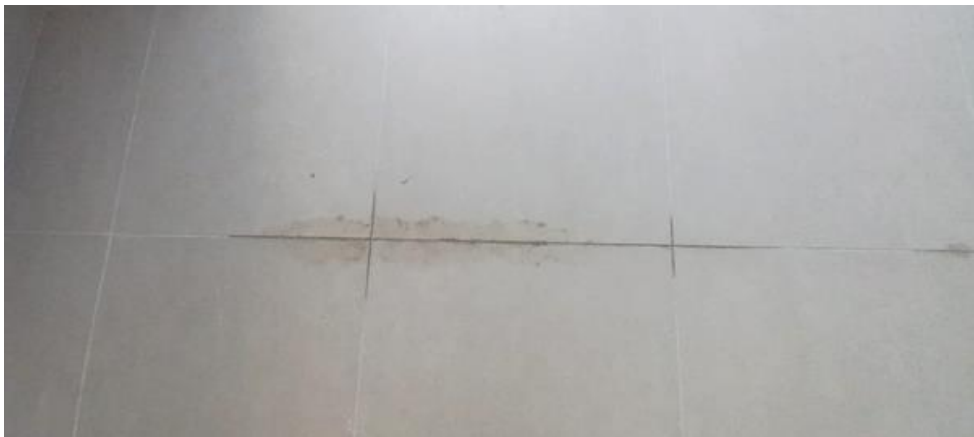
Figura 17 – Detalhe: manchas de eflorescência no piso
