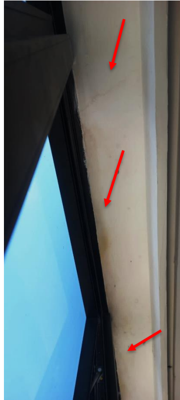
Figura 21 - Mancha de umidade no forro de gesso em apartamento do 8º pavimento
