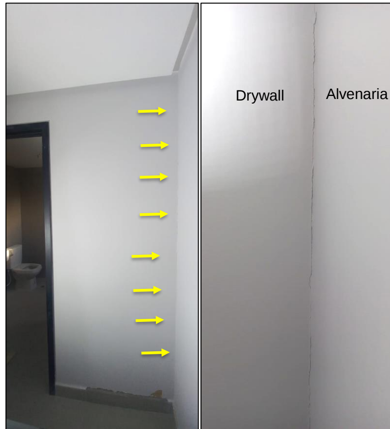
Figura 13 – Fissuras na interface drywall x alvenaria
