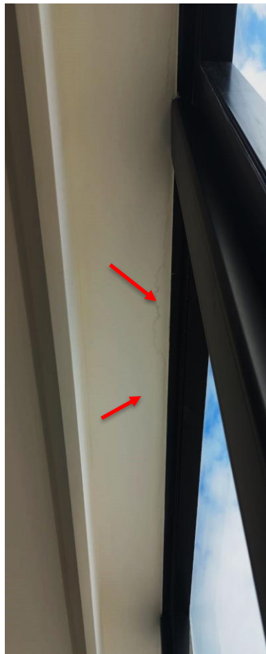
Figura 20 – Mancha de umidade no forro de gesso em apartamento do 7º pavimento
