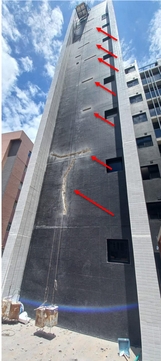
Figura 9 – Fissuras na fachada oeste
