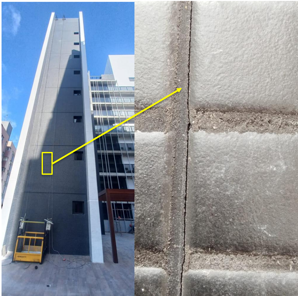
Figura 7 – Fissura vertical na fachada do edifício
