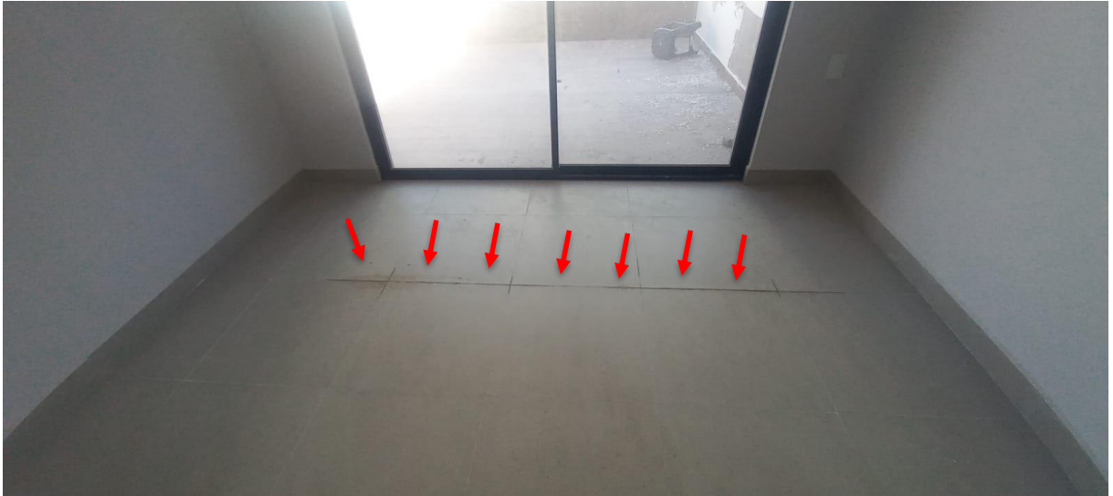
Figura 16 – Manchas de eflorescência no piso
