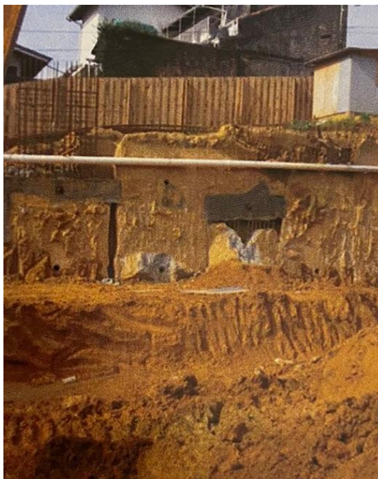
Figura 19 - Parede diafragma com problema na limpeza de fundo
