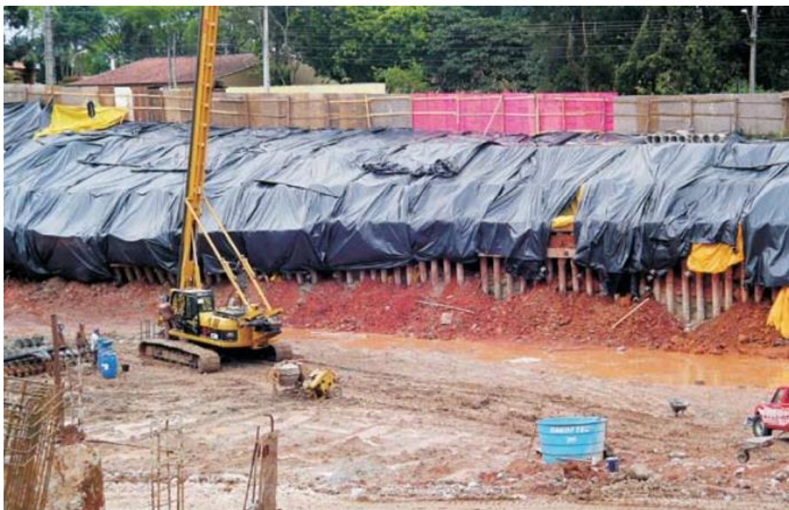
Figura 27 - Ruptura da cortina de contenção no lado (C)
