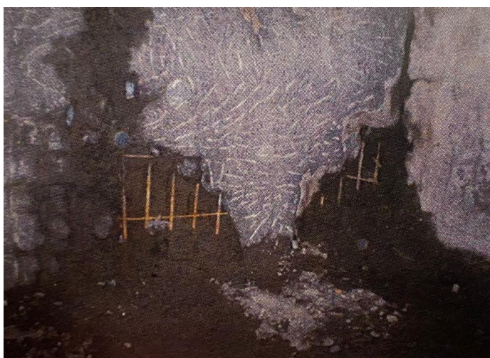
Figura 16 - Parede diafragma com problema na limpeza de fundo
