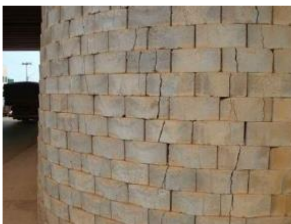
Figura 23 - Fissuras presentes em muro de arrimo
