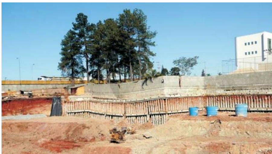
Figura 28 - Ruptura da cortina de contenção no lado (D).
