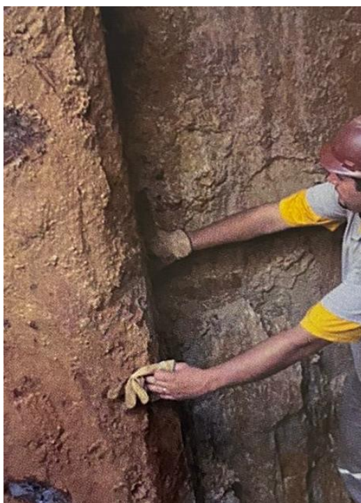
Figura 14 - Desaprumo de painéis de parede diafragma
