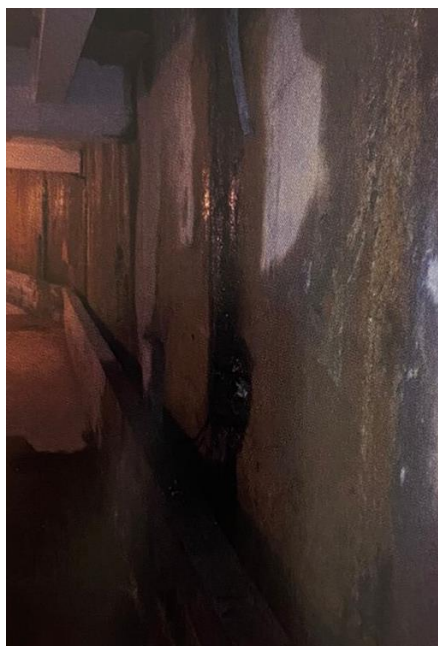
Figura 20 - Subsolo com problemas de drenagem
