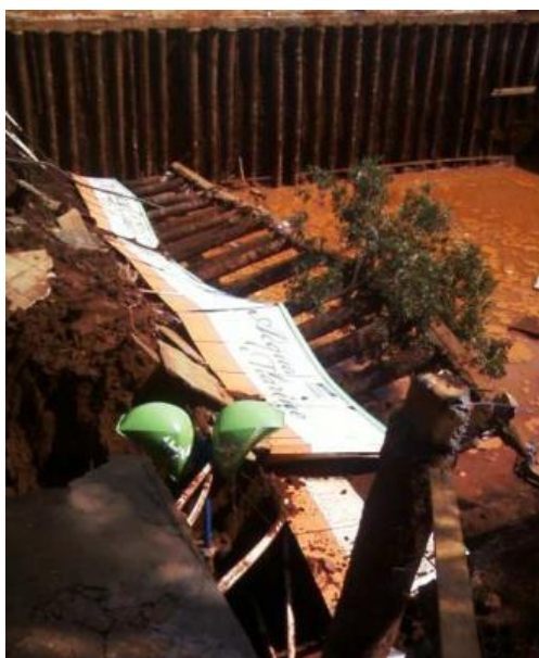
Figura 32 - Colapso de cortina de estacas em Maringá-PR
