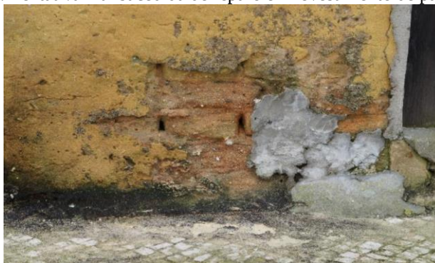
Figura 20: Tentativa mal sucedida de reparo em revestimento de parede
