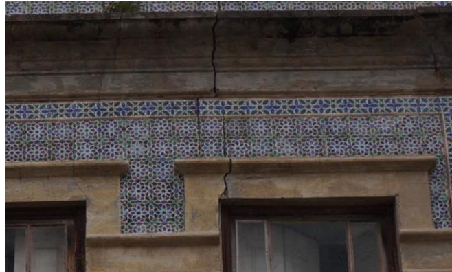
Figura 8: Casa de terra com estrutura visivelmente danificada em Aveiro - Portugal
