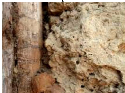
Figura 9: Ocorrência de cupins em casa colonial de terra
