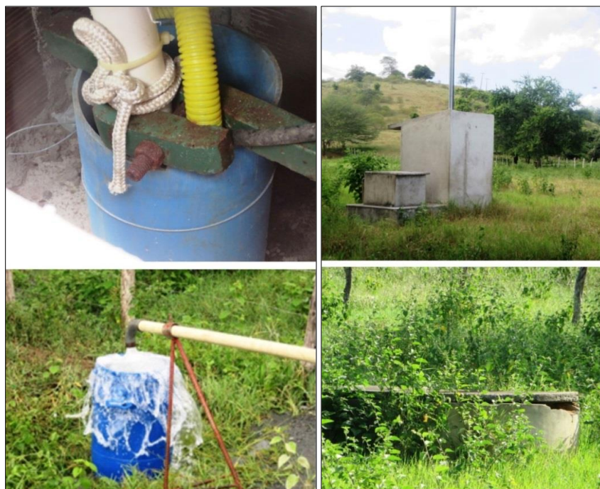
Figura 10. Poços tubulares da Várzea do Ipê (localizada a sudeste da cidade de Campina Grande).
