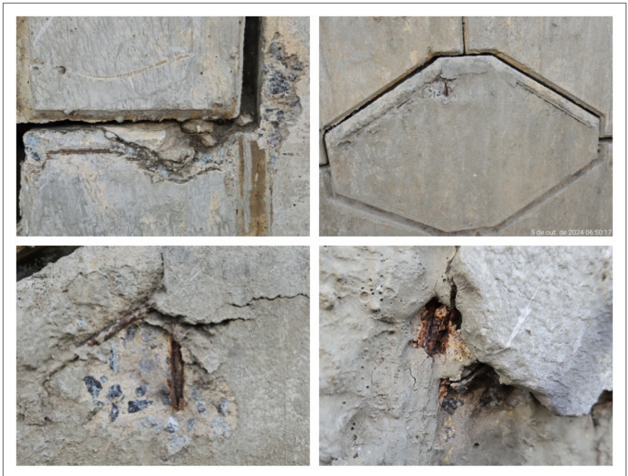
Figura 31 – Corrosão de armaduras nos painéis pré-moldados
