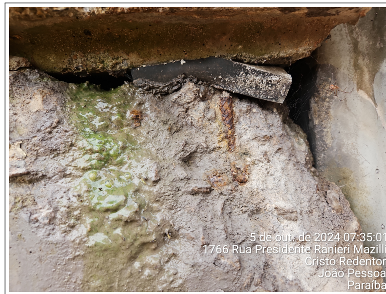
Figura 40 – Sinais de corrosão nas armaduras dos painéis
