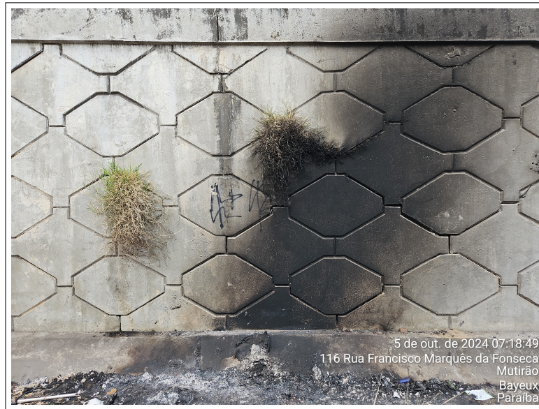
Figura 33 – Manchas causadas pelo fogo devido à queima de materiais nas proximidades da contenção
