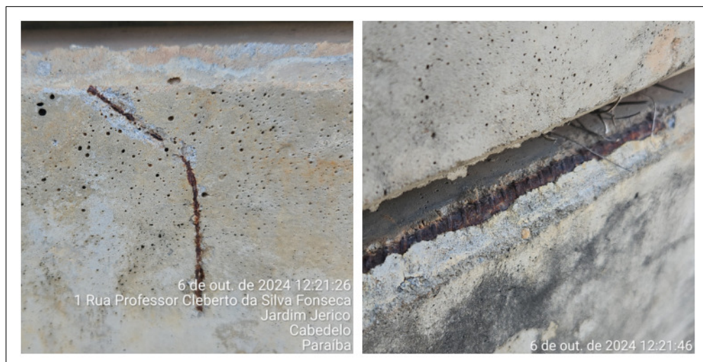
Figura 56 – Corrosão das armaduras
