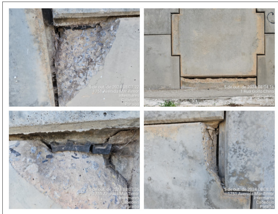
Figura 45 – Painéis pré-moldados danificados
