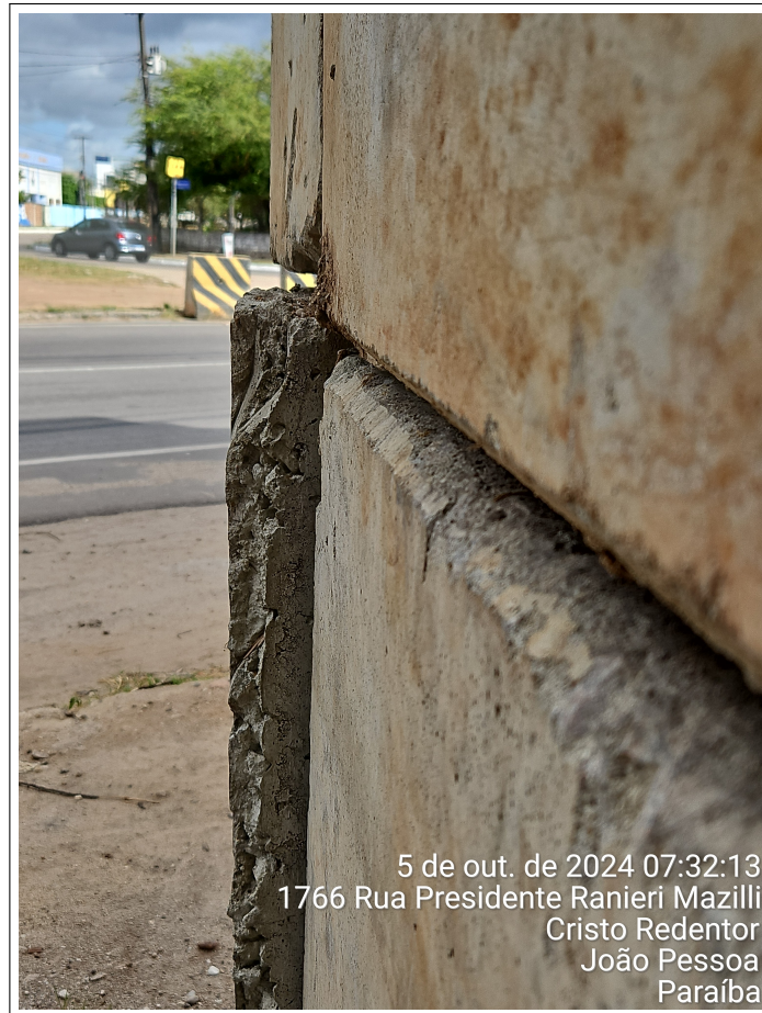
Figura 42 – Falhas na ligação entre as paredes frontais e longitudinais do muro
