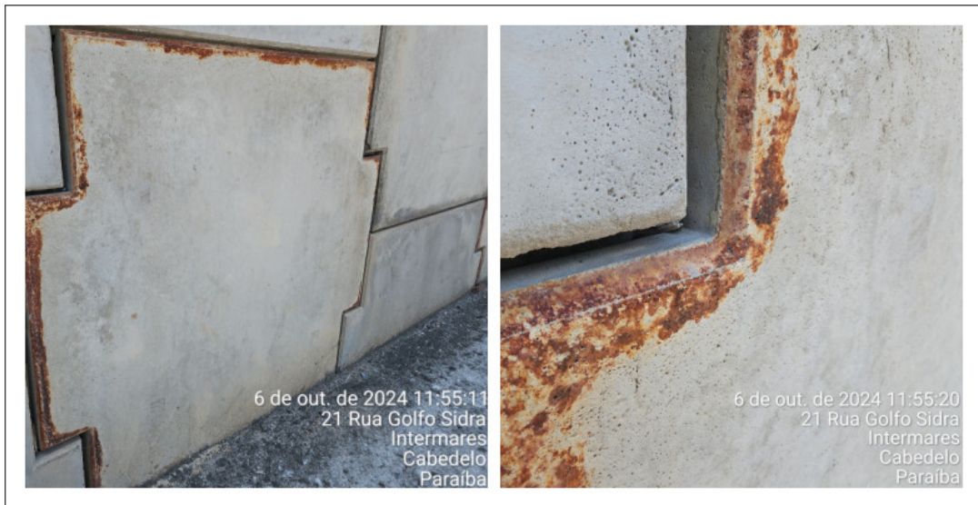
Figura 48 – Manchas semelhantes a ferrugem nos painéis pré-moldados do viaduto
