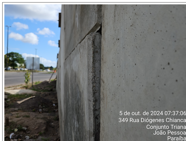
Figura 41 – Desnível entre painéis do muro
