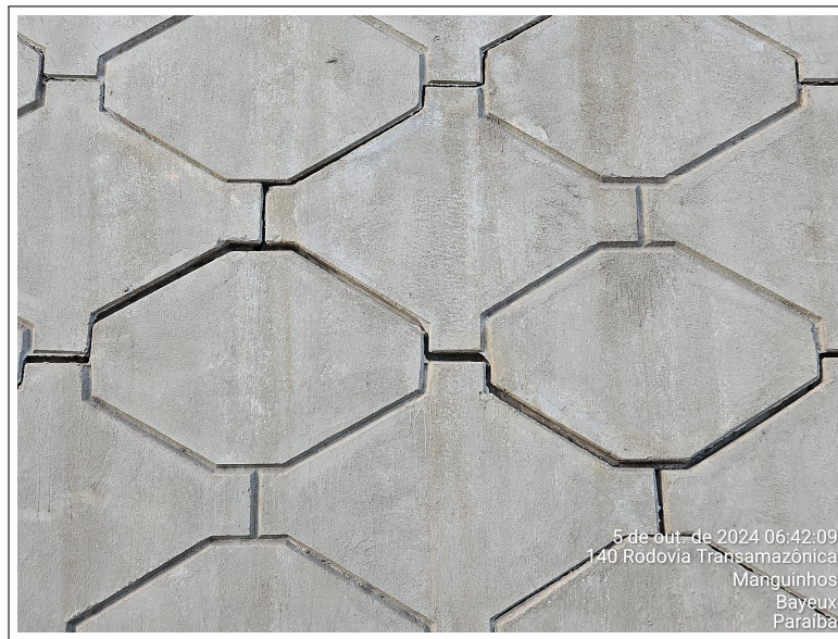
Figura 36 – Desaprumo dos painéis no muro
