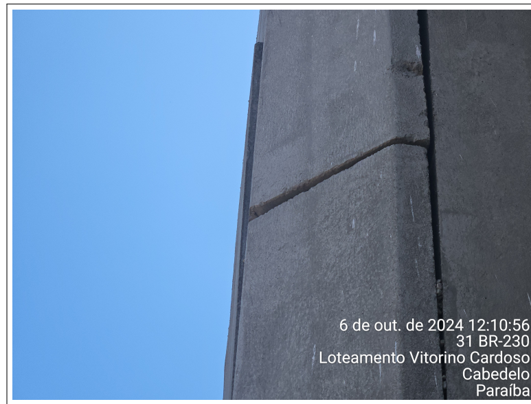
Figura 54 – Falha na ligação entre as paredes frontais e longitudinais do muro
