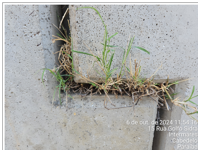
Figura 49 – Presença de vegetação em pontos isolados
