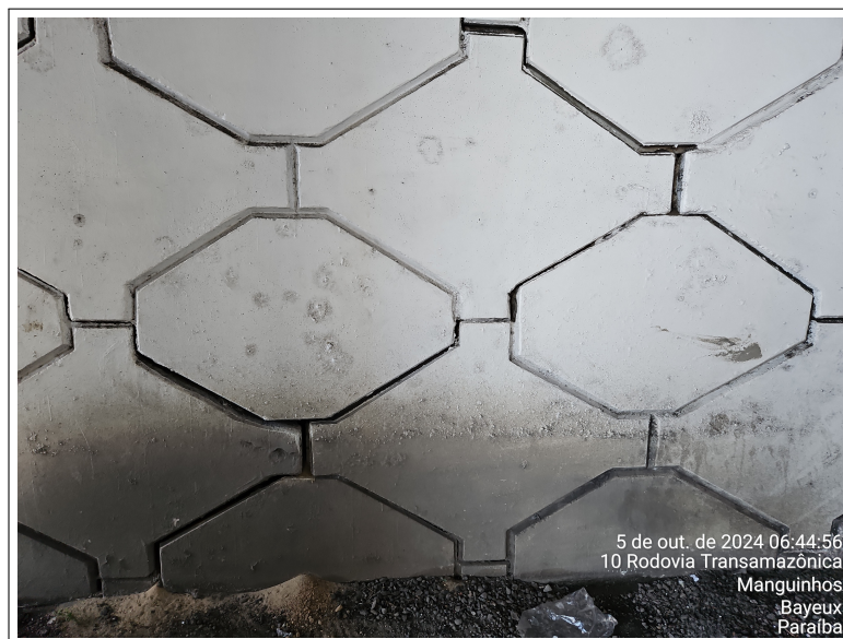
Figura 34 – Manchas na parte inferior do viaduto, indicativas da ascensão de água por capilaridade
