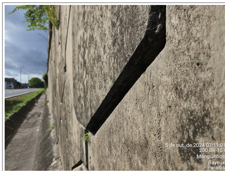
Figura 37 – Painéis desnivelados na estrutura do viaduto
