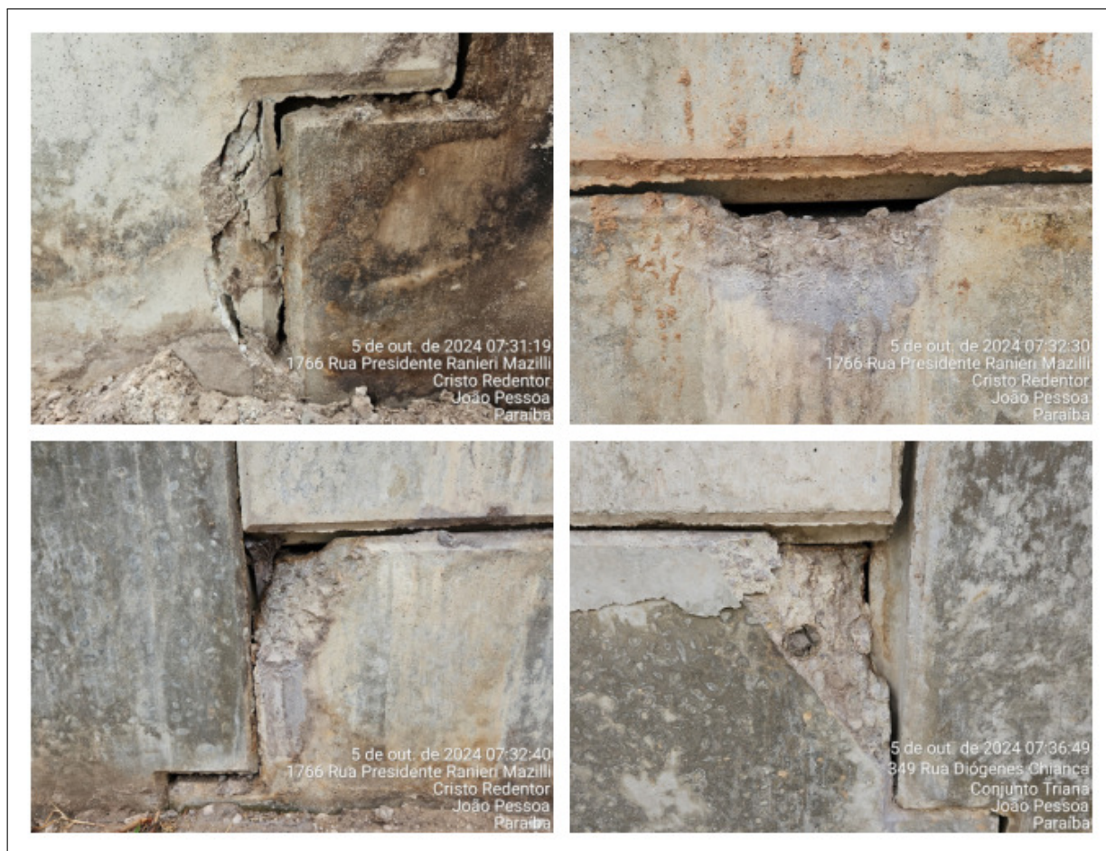
Figura 39 – Painéis pré-moldados danificados
