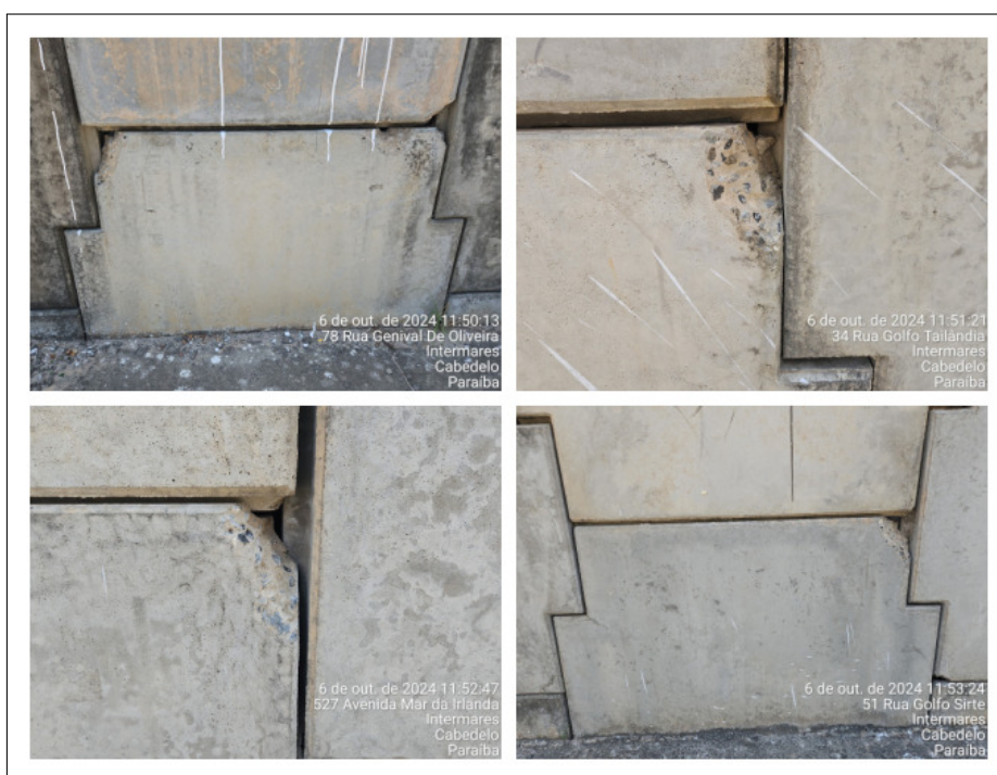
Figura 47 – Painéis pré-moldados danificados
