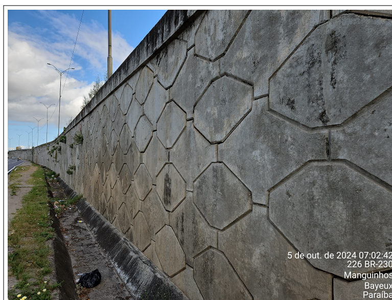
Figura 32 – Painéis pré-moldados apresentando manchas de diferentes tonalidades, resultantes da ação da água nas superfícies
