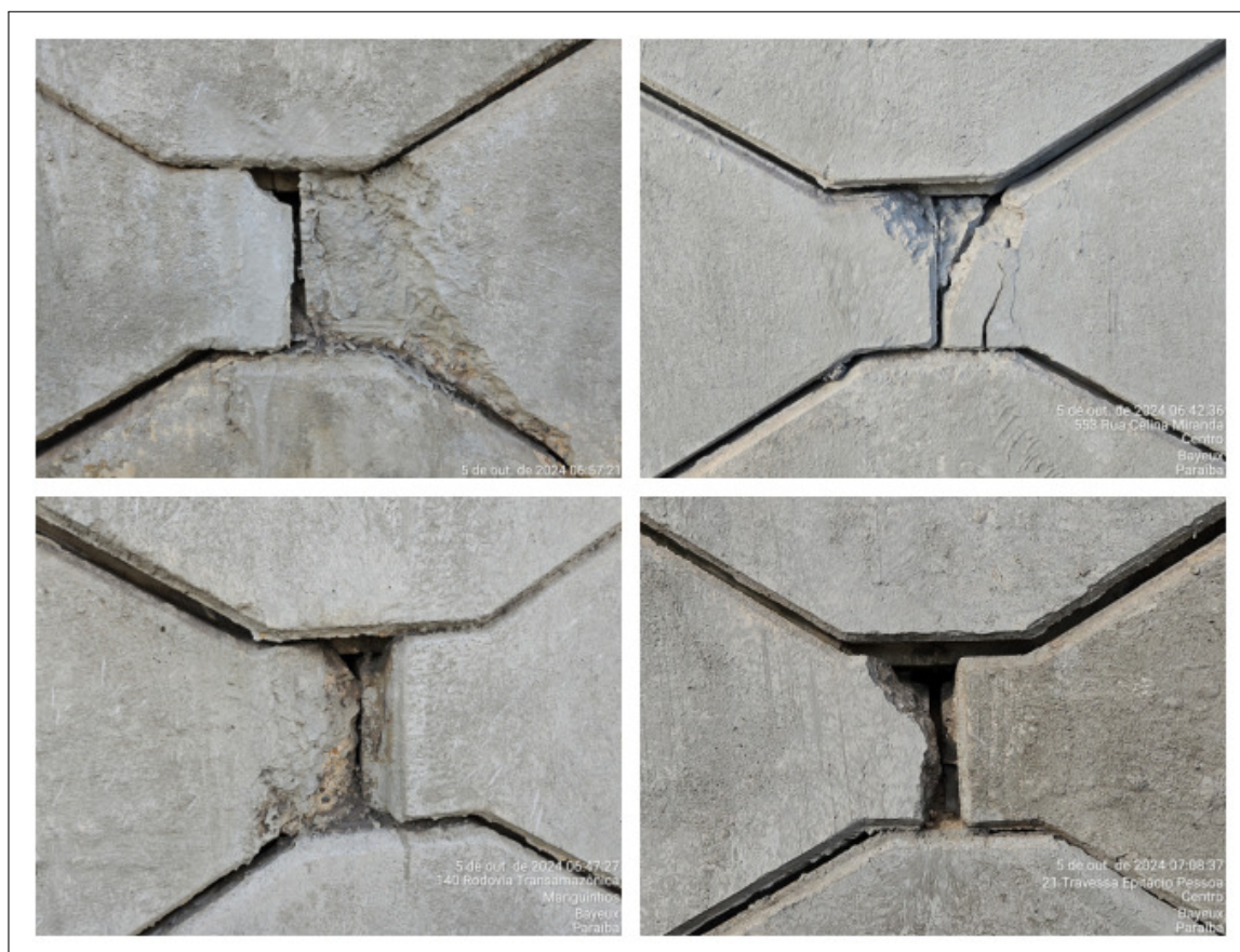
Figura 30 – Painéis pré-moldados danificados
