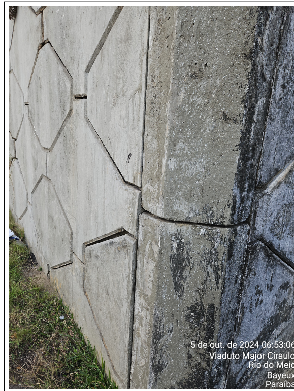
Figura 38 – Falhas na ligação entre as paredes frontais e longitudinais do muro
