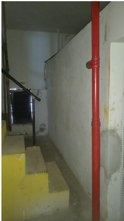
Figura 23 – Tubulação de incêndio
