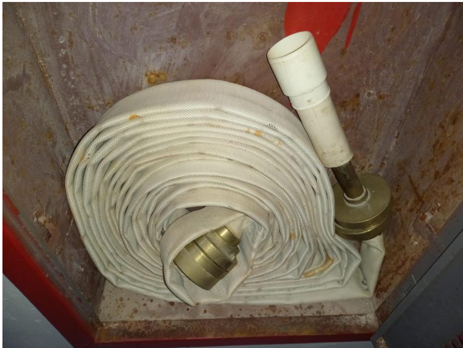
Figura 21 – Mangueira de hidrante com esguicho
