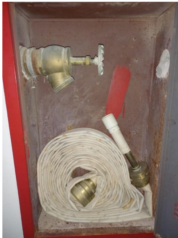
Figura 12 – Caixa de hidrante com acessórios
