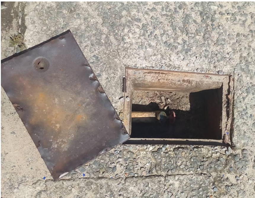
Figura 25 - Caixa do hidrante de passeio
