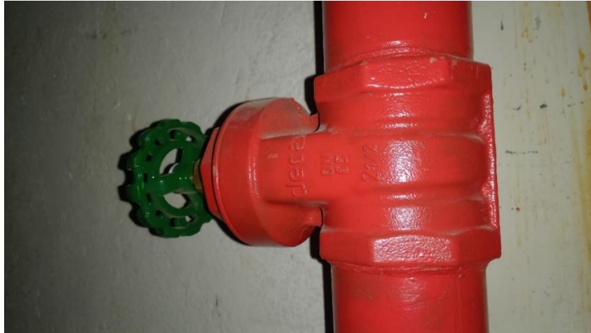
Figura 22 – Válvula de retenção na tubulação de incêndio
