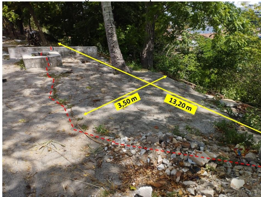
Figura 43 - trinca no topo do talude
