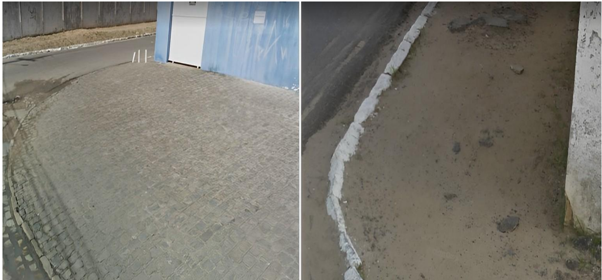
Figura 42: Diferença de largura entre calçadas do subtrecho I
