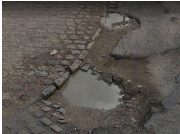
Figura 41: Buracos na interseção entre os subtrechos H e I
