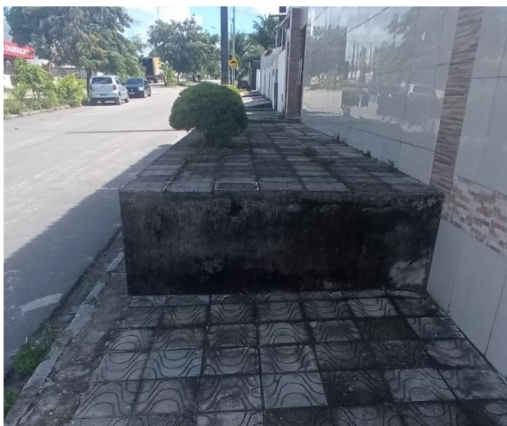
Figura 46: Desnível acentuado observado no subtrecho E
