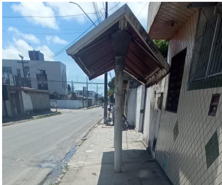
Figura 37: Ponto de ônibus sobre calçada no trecho 2
