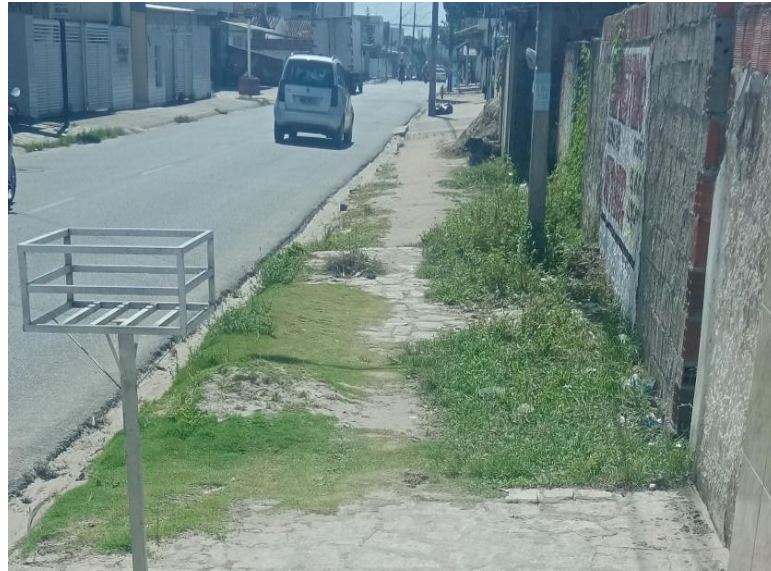
Figura 47: Calçada sem pavimento no subtrecho C
