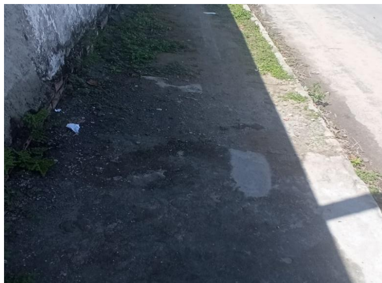
Figura 45: Descontinuidade de calçada no subtrecho E
