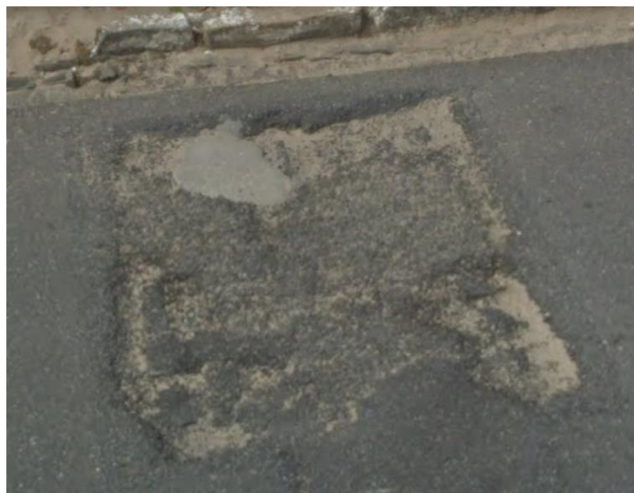
Figura 35: Buraco em via do trecho 3
