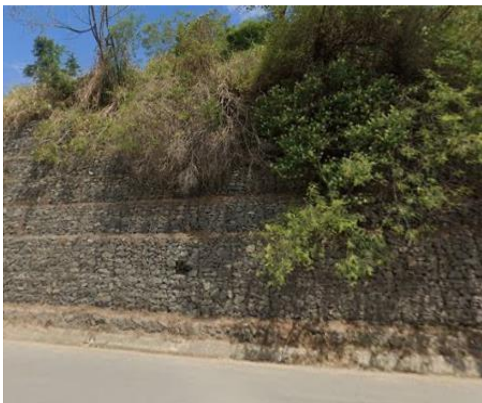
Figura 29: Talude de solo podzólico
