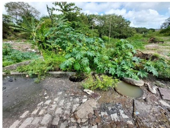
Figura 18: Esgoto estourado acima do Ponto A.
