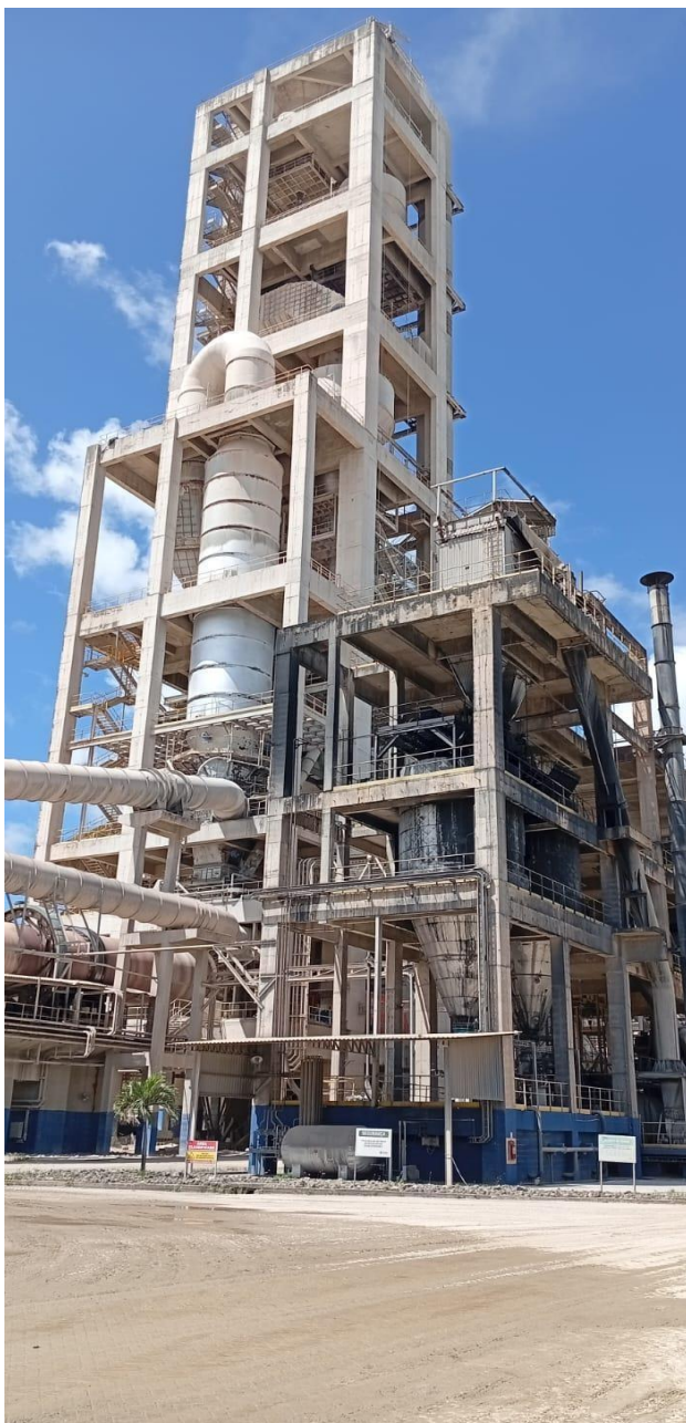
Figura 10 - Torre de Ciclone
