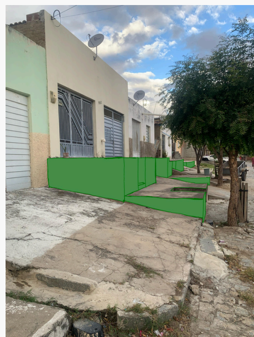
FIGURA 106: DESNÍVEL DA CALÇADA
