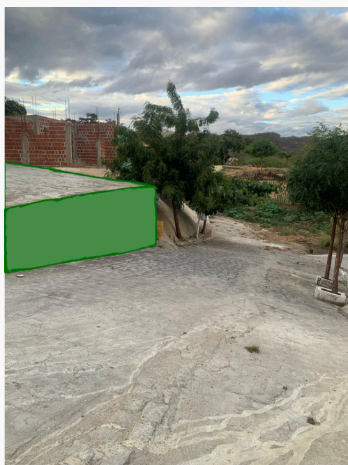
FIGURA 105: DESNÍVEL DA CALÇADA
