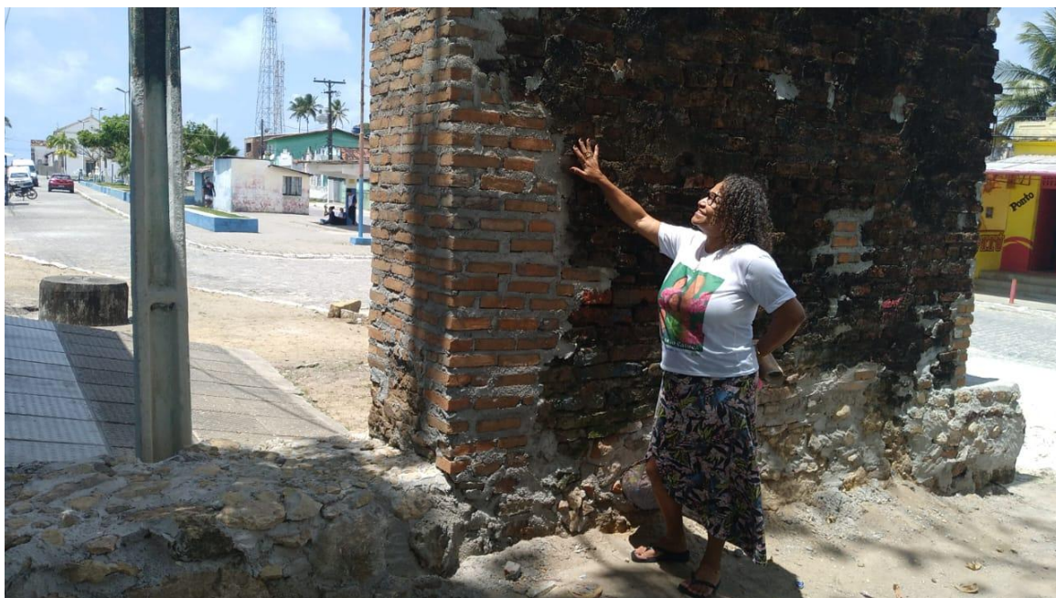
Fotografia do autor: Ruínas após trabalho de contenção – novembro de 2022.
