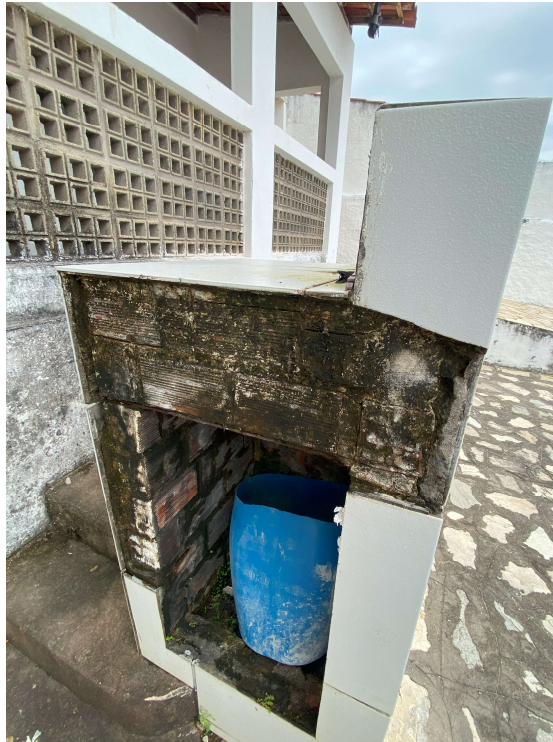
Figura 23: Foto 39 da inspeção predial
