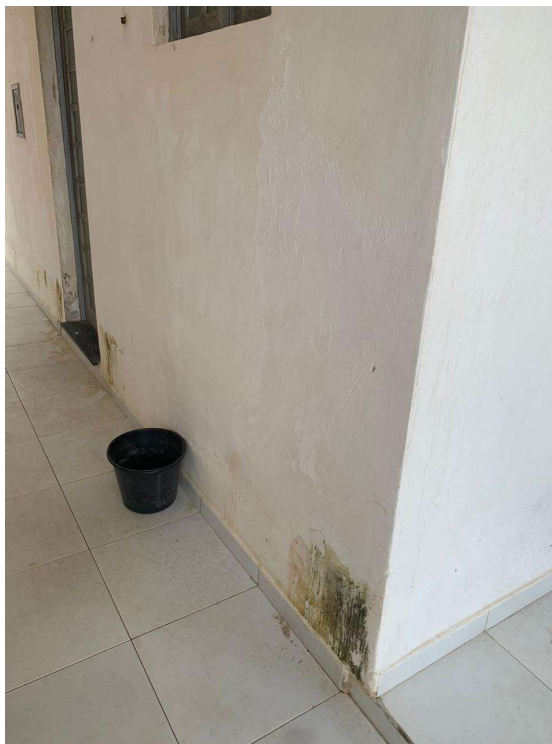
Figura 29: Foto 110 da inspeção predial
