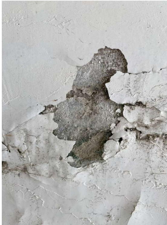
Figura 27: Foto 50 da inspeção predial
