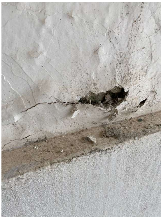
Figura 28: Foto 51 da inspeção predial
