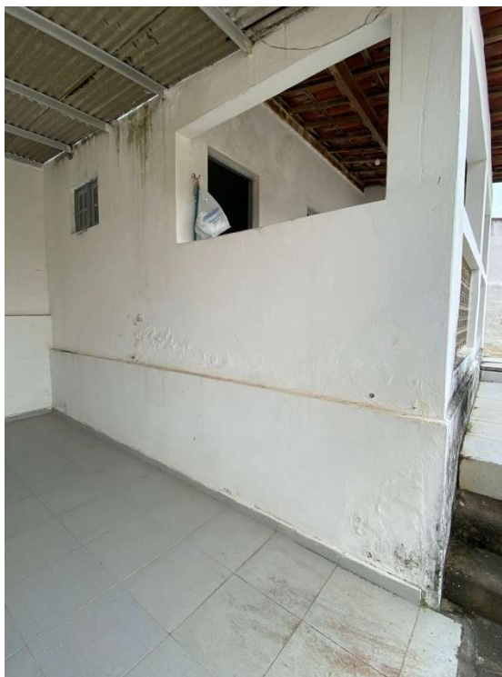
Figura 24: Foto 46 da inspeção predial
