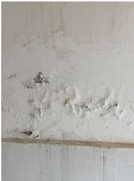
Figura 25: Foto 48 da inspeção predial
