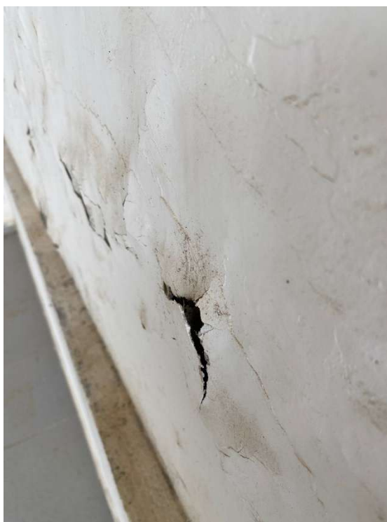
Figura 26: Foto 49 da inspeção predial
