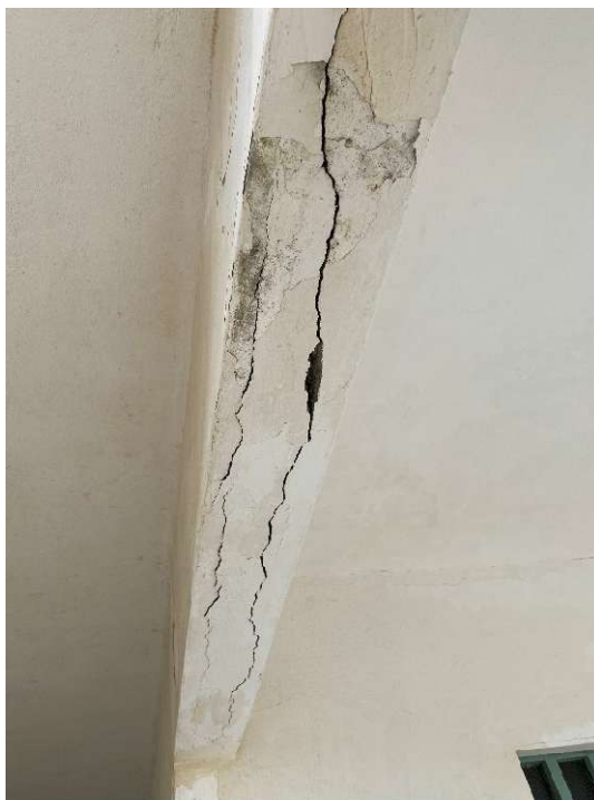
Figura 22: Foto 102 da inspeção predial
