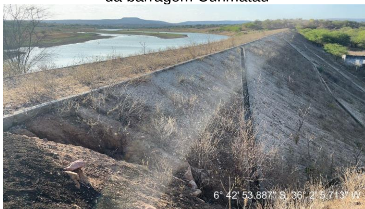
Figura 19 - Presença de erosão no talude de jusante da barragem Curimataú
