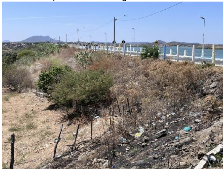
Figura 16 - Presença de árvores e arbustos no talude de jusante na barragem Estevam Marinho
