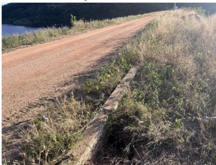
Figura 17 - Sarjeta obstruída na barragem Engenheiro Ávidos
