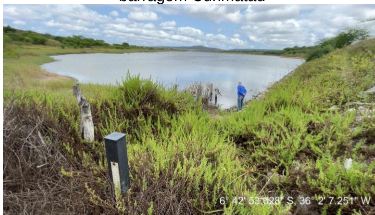
Figura 18 - Réguas milimétricas quebradas na barragem Curimataú
