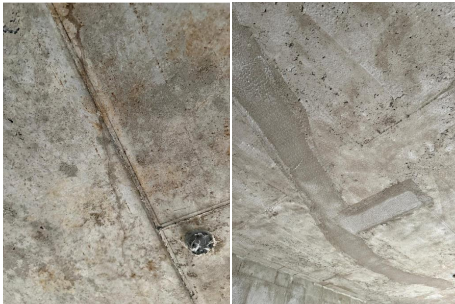
Figura 53 – Fissura em Estrutura de Parede de Concreto
