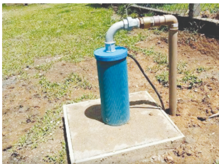
(b) Estrutura de captação subterrânea
