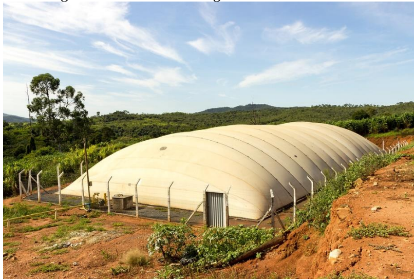
Figura 11- modelo de biodigestor canadense instalado
