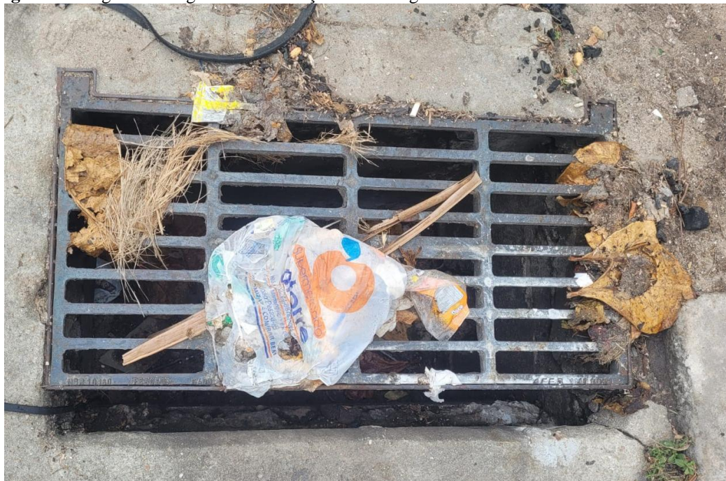
Figura 51. Registros fotográficos da situação atual das grelhas no trecho Rui Barbosa × Manoel Deodato.
