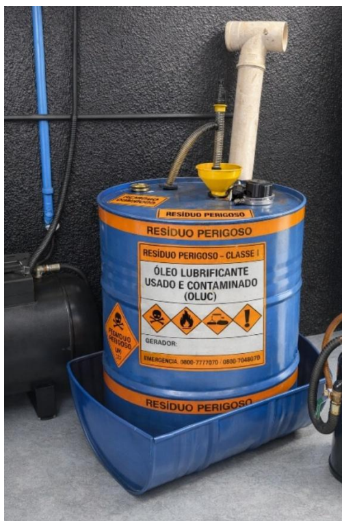
Figura 12 - Exemplo ilustrativo de bacia de contenção improvisada para armazenamento de resíduos perigosos
