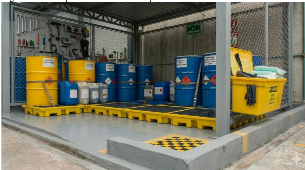
Figura 4 - Ilustração de bacia de contenção em área de armazenamento de resíduos perigosos
