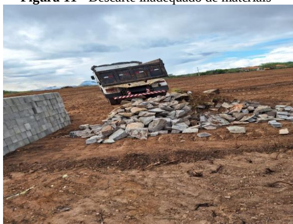
Figura 11 - Descarte inadequado de materiais
