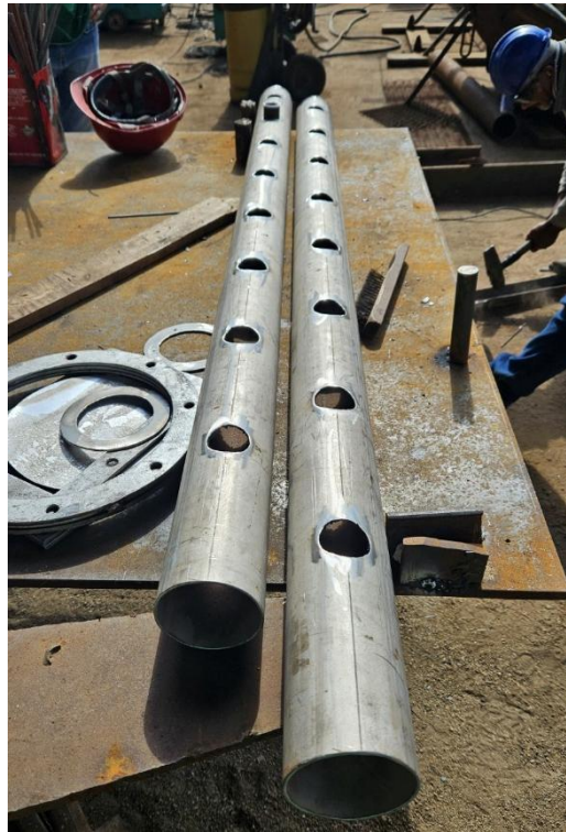
Figura 8 – Linha de pulverização confeccionada em tubos metálicos
