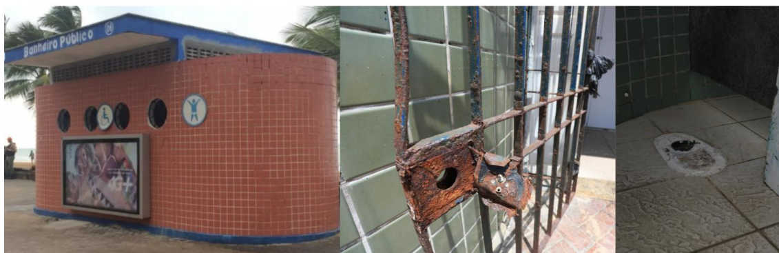
Figura 2. Banheiro público da orla de Recife antes da reforma.
