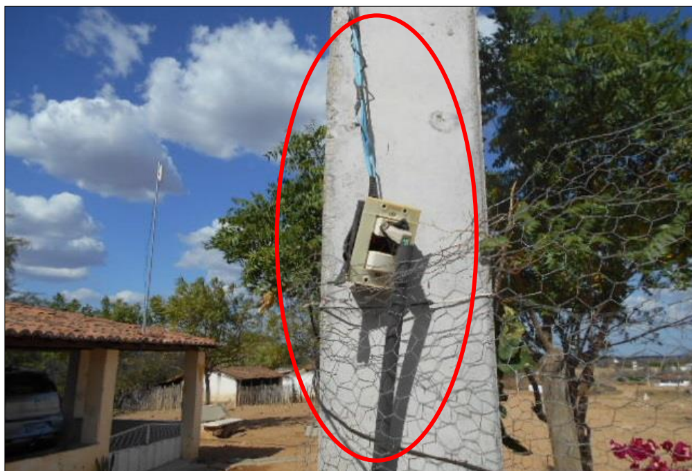
Figura 14 – Desvio de energia no ramal de ligação 3.2.
