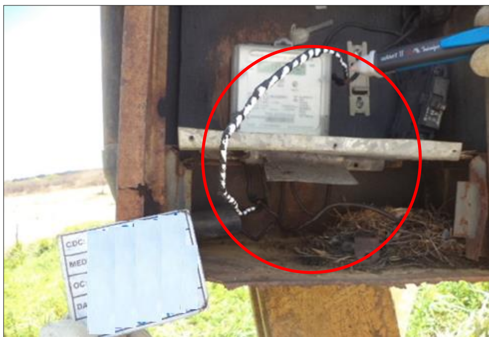
Figura 8 – Desvio de energia no ramal de entrada 1.
