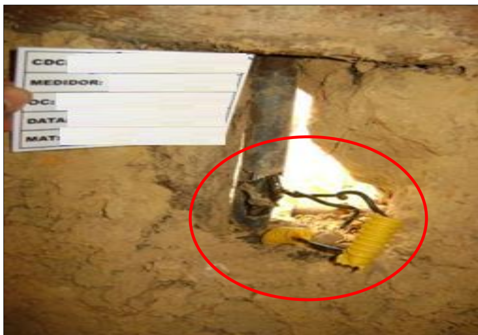
Figura 10 – Desvio de energia no ramal de entrada 3.
