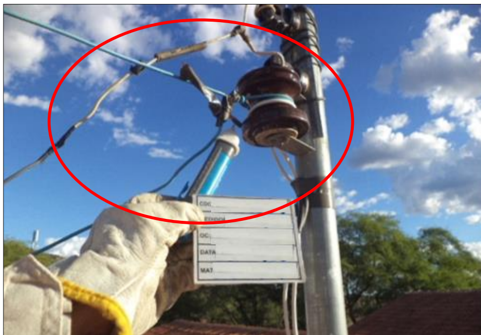
Figura 9 – Desvio de energia no ramal de entrada 2.
