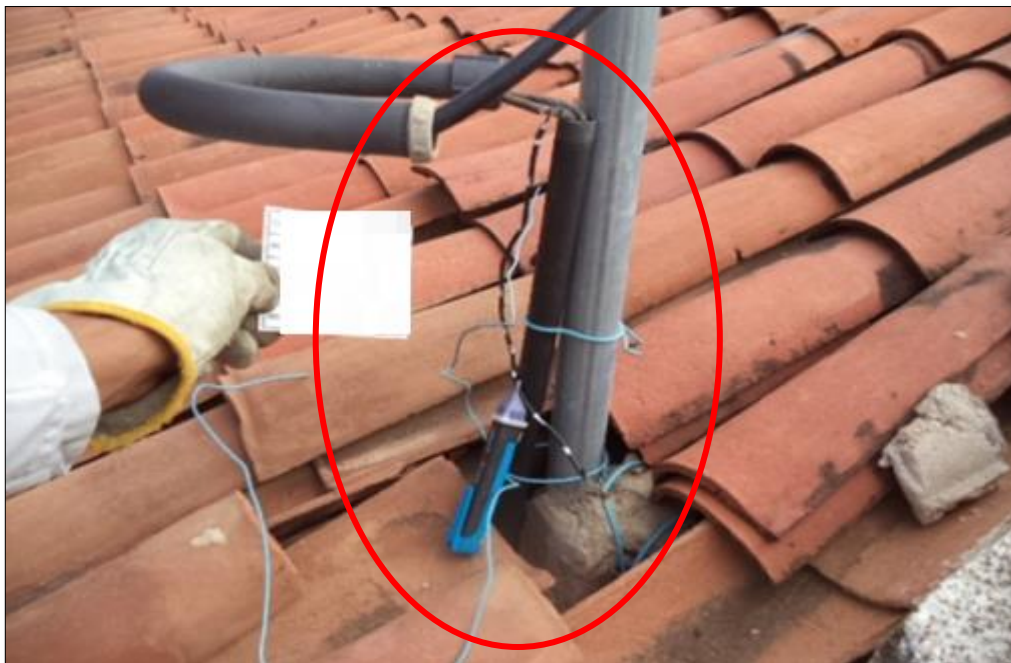
Figura 11 – Desvio de energia no ramal de ligação 1.
