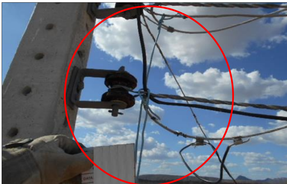
Figura 13 – Desvio de energia no ramal de ligação 3.1.
