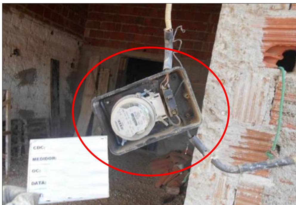
Figura 24 – Medidor Inclinado/Deitado – Intervenção de terceiros.
