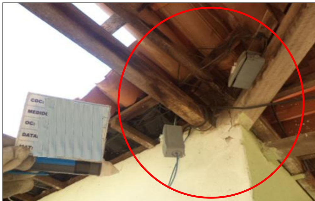
Figura 12 – Desvio de energia no ramal de ligação 2.
