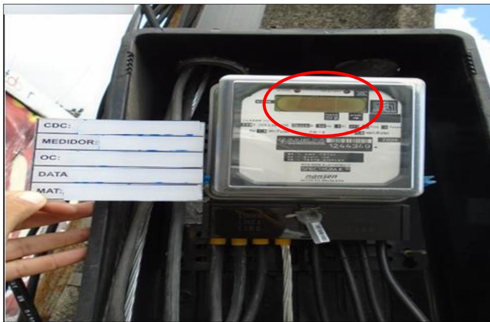
Figura 3 - Medidor de energia com os lacres intactos, display apagado não emite Pulsos. Medidor com defeito técnico.
