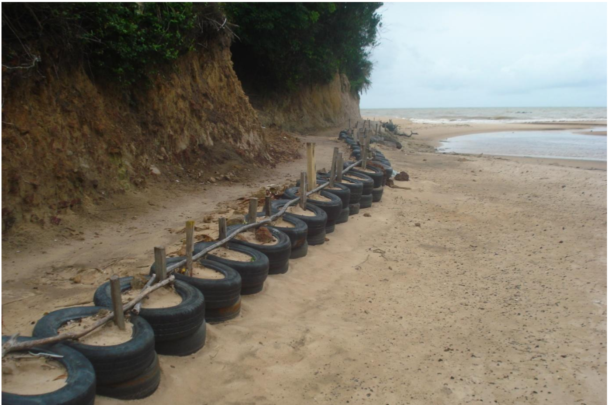
Foto 06. Barreira de pneus construída para impedir a erosão da falésia e a passagem dos frequentadores (Foto: Dennys Bizerra, maio de 2011).
