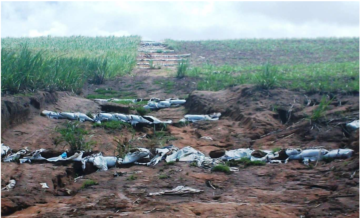
Foto 6 - Colocação de sacos de areia no intuito de conter a erosão na vertente. Essa situação é percebida ao longo de toda a estrada que liga a BR 101 ao Distrito de Forte Velho, Santa Rita – PB. Fonte: avervo do autor. Data 05/06/2013.
