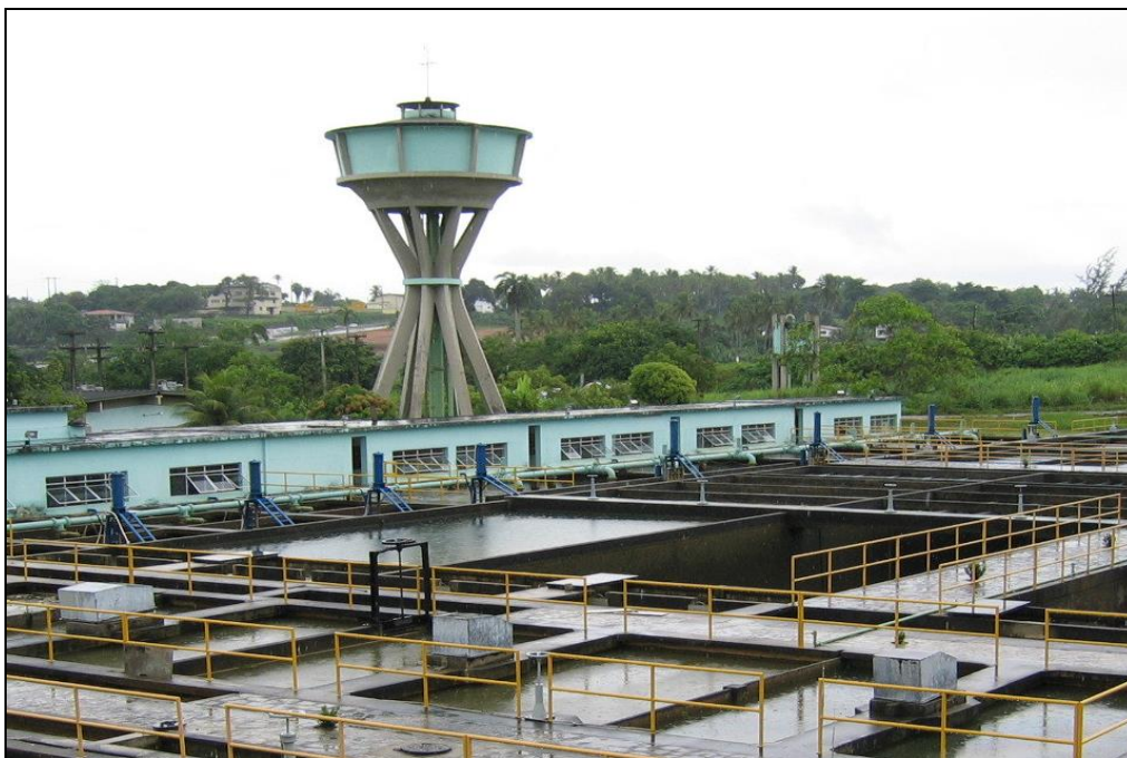
Figura 3- Estação de Tratamento do Reservatório de Marés.
