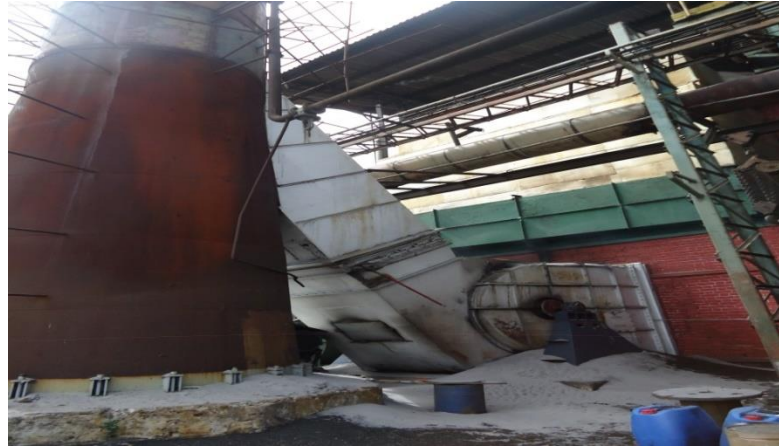
Figura 8 - Chaminé e exaustor
