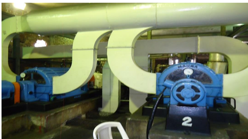
Figura 1 – Geradores da Usina Agroval
